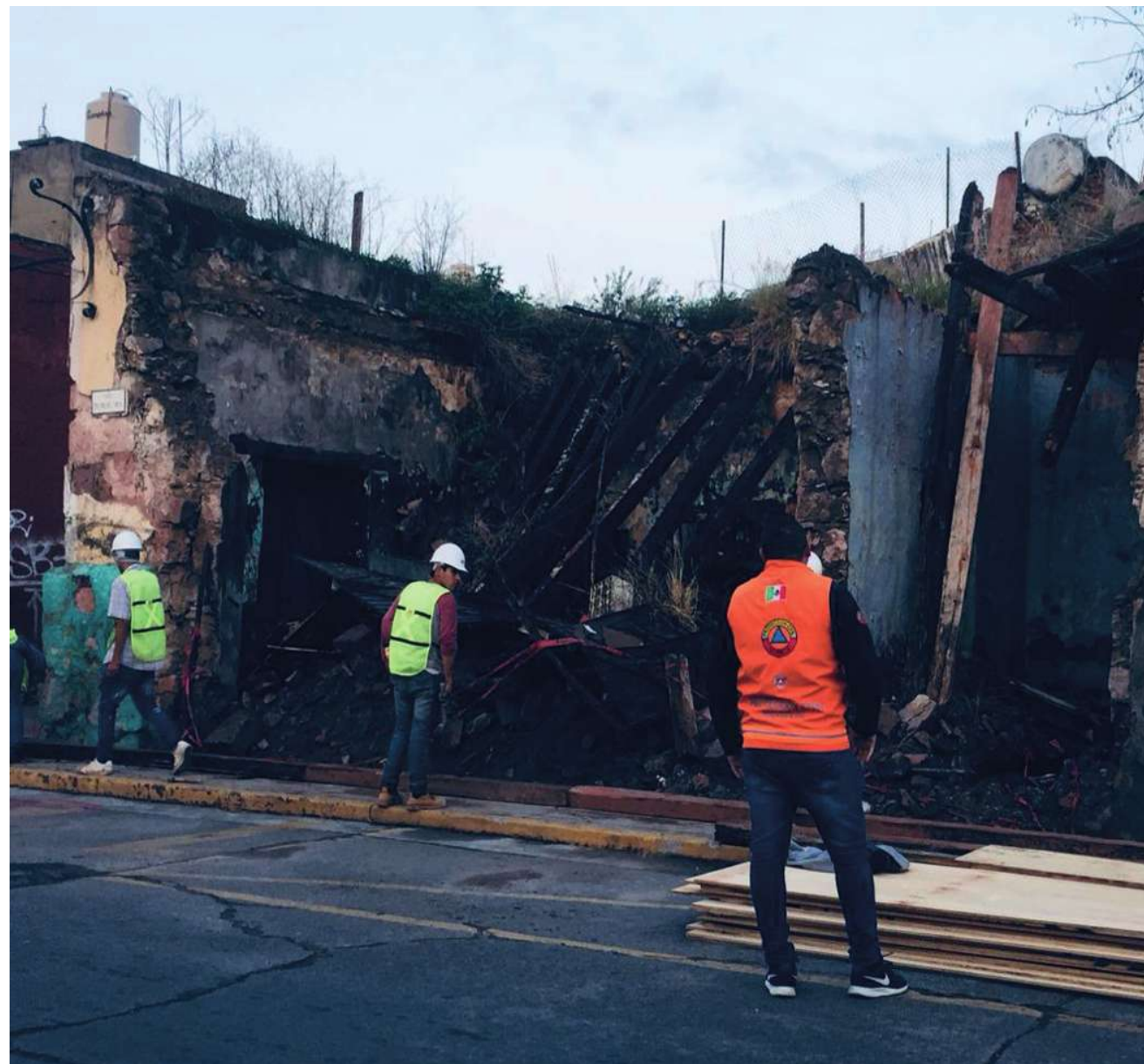
Fotografía 3: Fachada Este, la cual se encuentra en pérdida total. Fuente: Coordinación del centro histórico de Morelia, Michoacán
