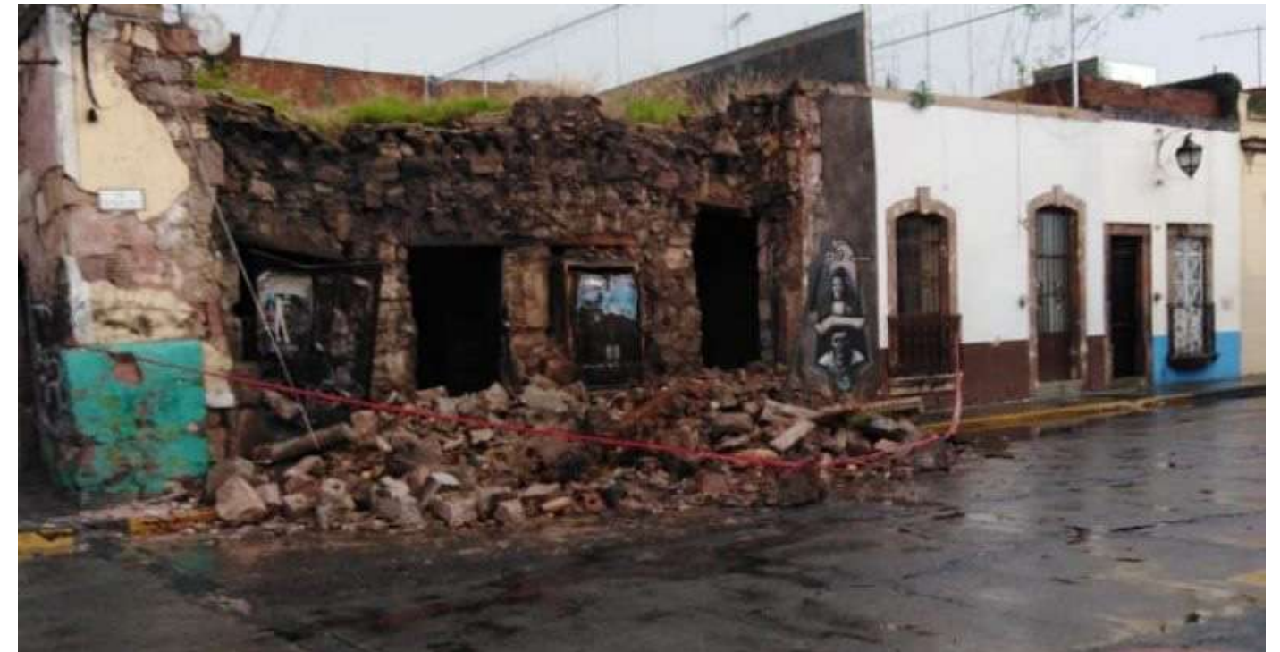
Fotografía 9 : Derrumbe en fachada. Fotografía: www.atiempo.mx/destacadas/por-intensa-lluvia-se-derrumba-casa-en-centro-historico-de-morelia/
