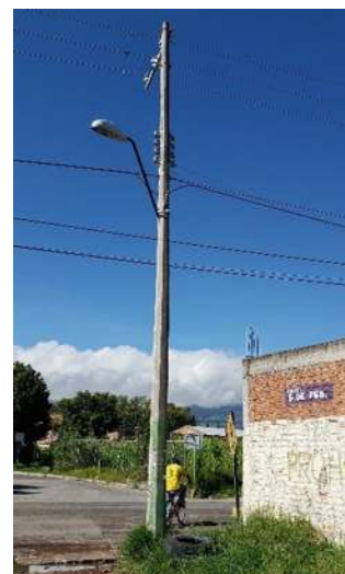
Fig. 22 Poste de la red eléctrica y alumbrado, Calle 5 de febrero y Venustiano carranza, Foto propia [21-octubre-19]
