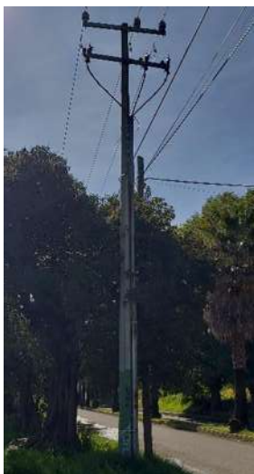
Fig. 20 Poste de la red eléctrica, Calle Venustiano carranza, Foto propia [21-octubre-19]
