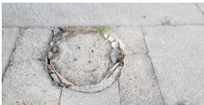
Fig.17 Pozo de visita sanitario, Calle Venustiano Carranza y calle 5 de febrero, Foto propia [21-octubre-19]
