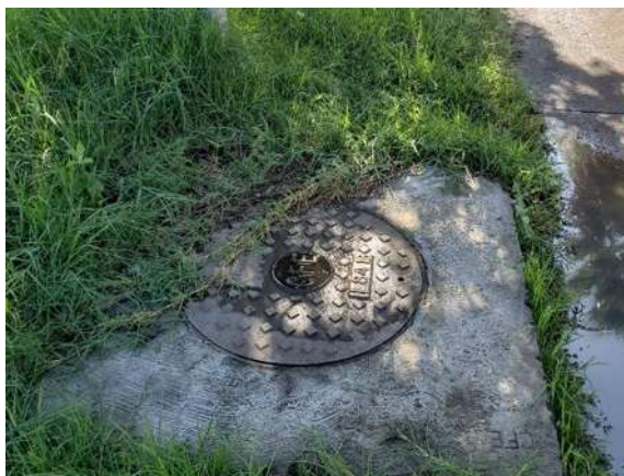
Fig. 21 Pozo de visita red eléctrica, calle Venustiano carranza, Foto propia [21-octubre-19]
