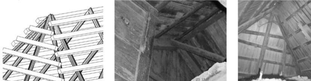
Fig. 14 Estructura de madera en cubierta de troje con tejamanil, Obtenido de: (La troje michoacana, Bedolla).
