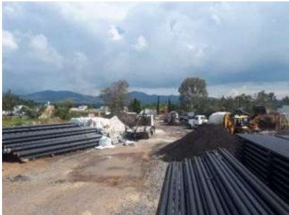
Fotografía No. 2. Tuberías con recubrimiento especial. Fotografía del autor.
