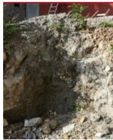
Imagen 112 Grieta expuesta en corte de terreno. Nota: Después de encontrar la grieta en el área de la zapata se hicieron revisiones oculares en los diferentes cortes del terreno para poder encontrar la dirección de la grieta, encontrando 5 grietas expuestas en estos cortes.
