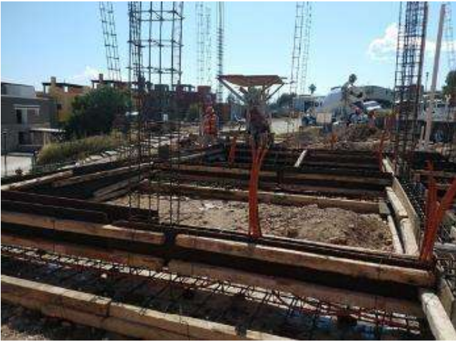
Imagen 97 Habilitado y colocación de cimbra. Nota: Se le llama obra falsa y/o moldes que sirven para soportar y moldear el concreto de acuerdo a las especificaciones durante el tiempo que se requiere para que alcance su resistencia necesaria.
