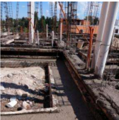
Imagen 98 Colado de zapatas, cadenas, descimbrado, relleno y compactación de terrenos y habilitado de instalaciones.
