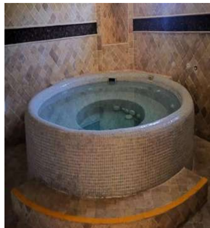
Imagen 93 Área de jacuzzi. Nota: En esta área se realizó el mantenimiento del veneciano ya que se estaba cayendo porque no usaron el adhesivo correcto.
