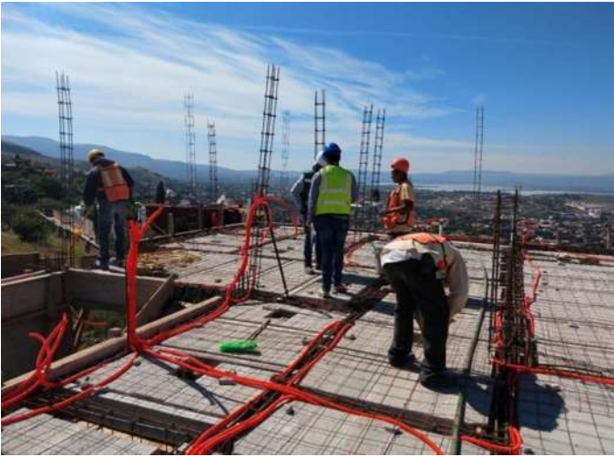
Imagen 103 Habilitado de instalaciones y colocación de malla. Nota: las instalaciones eléctricas se colocan sobre o entre la bovedilla y si hay cajas se quita una bovedilla donde se instalará y se pone una tabla debajo de la caja y se amarra con alambre recocido a las diagonales de la armadura. La malla se corta según las medidas requeridas y se amarra a cada 50 cm a la varilla superior de la vigueta.
