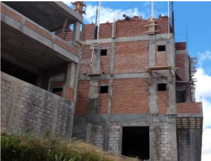
Imagen 100 Habilitado de muros. Nota: Es la ejecución de muros de tabique recocido con medias de 7 \times 14 \times 28 para hacer las divisiones de las diferentes áreas que conforman el edificio.
