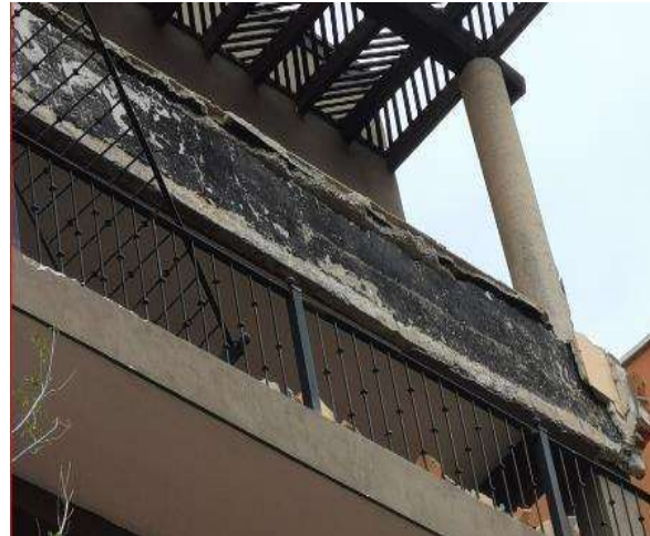
Imagen 114 vista desde debajo de frente del volado colgado. Nota: el volado se colgó por hecho de que el acero se encontraba en el lecho inferior y no cumplía la función.
