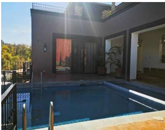
Imagen 92 Área de alberca dentro de la casa club 01. Nota: En esta área se a realizado el mantenimiento de la alberca que consto de colocar parte del veneciano ya que se estaba cayendo porque no usaron el adhesivo correcto.
