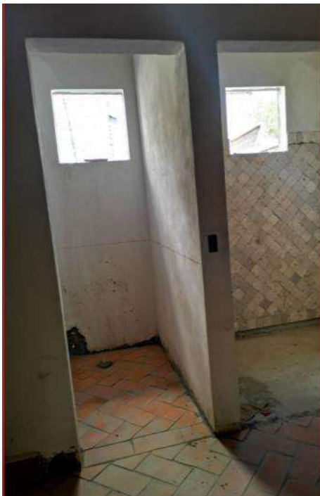
Imagen 105 Colocación de piso, zoclo y mármol en baños. Nota: El piso y zoclo que se coloca en cada villa son de barro rustico de la región, el piso es de formato de 30x30 y el zoclo de 8x30 son pegados y junteados con mortero y arena fina y el mármol es de un formato de 10x10 con acabado tomboleado que se refiere que la superficie semi-pulida ligeramente alterada pegado con pega piso.
