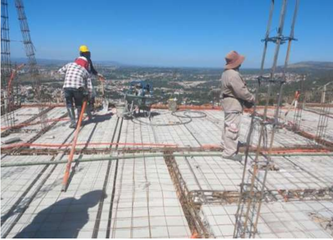
Imagen 101 Habilitado, colocación de acero en trabes, cerramiento, cadenas y suministro y colocación de vigueta y bovedilla.
