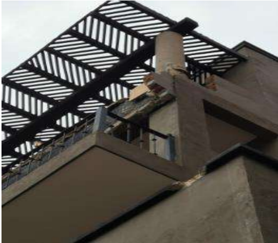
Imagen 113 Vista desde abajo lado derecho del volado colgado. Nota: Al momento que se colgó el volado había una persona sobre por lo cual cayó y murió en ese momento.
