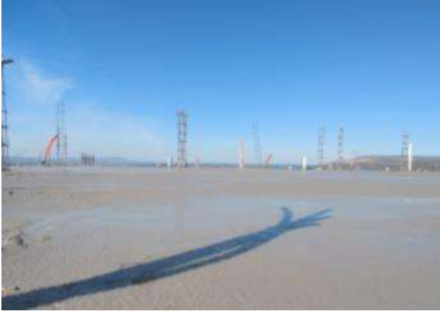
Imagen 99 Colocación de malla y colado de firme. Nota: La función de la malla en el firme reforzar el elemento, así como el colado de este, el concreto que se utiliza es una resistencia de un F'c= 200 \text{ kg/cm}^2 .
