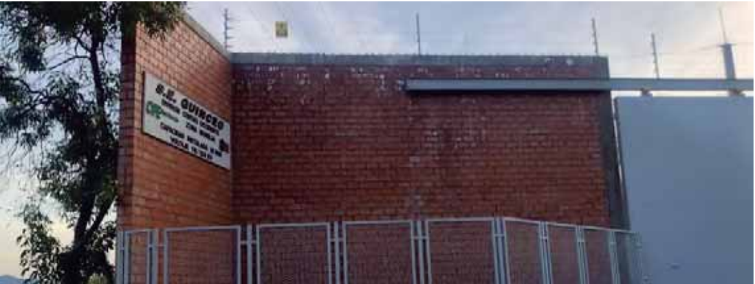
Fig. 4.2. Sub Estación Quinceo. Fuente: MALV.
