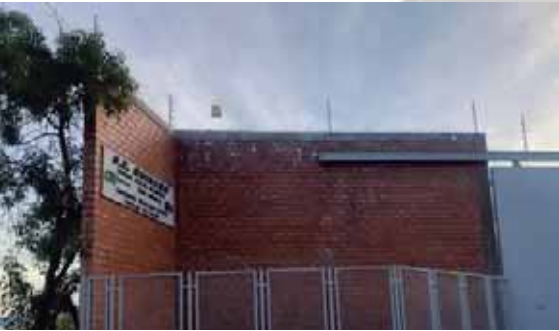
Fig. 4.9. Sub estación que alimenta la zona. Fuente: MALV.
