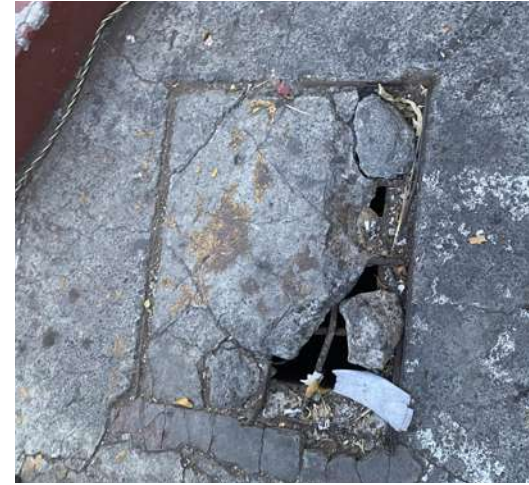
Gráfico 4.39, Registro en mal estado, R. Hilda Arroyo, 2021.
