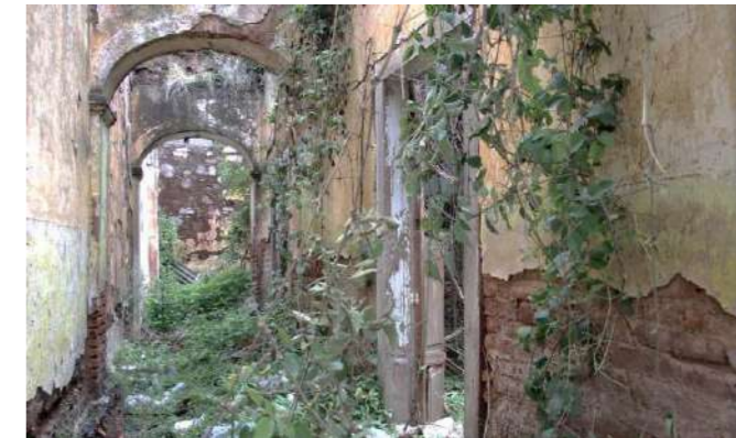
Ilustración 19 “Vivienda abandonada, Morelia”. Fuente: El Sol de Morelia. URL: https://www.elsoldemorelia.com.mx/local/en-riesgo-200-inmuebles-del-centro-historico-de-morelia-3935035.html
