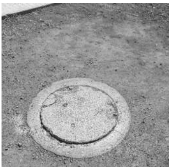
fig.3. 6 Servicio de drenaje en las calles aledañas del terreno.
