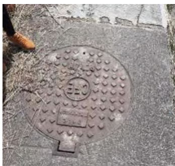
fig.3. 13 Servicio de energía eléctrica. Fuente: propia
