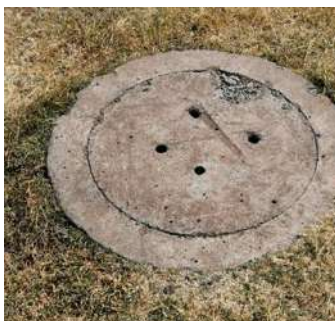
fig.3. 8 Servicio de drenaje en las calles aledañas del terreno.
