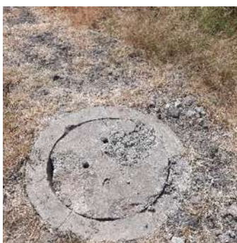
fig.3. 7 Servicio de drenaje en las calles aledañas del terreno.
