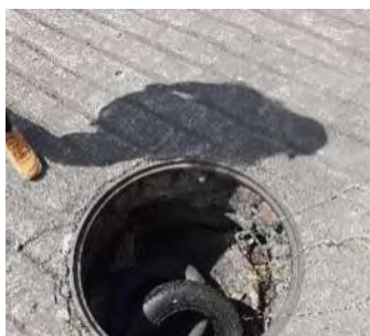
fig.3. 9 Servicio de drenaje en las calles aledañas del terreno.
