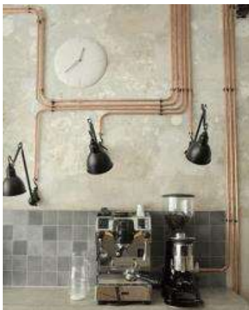
Imagen 75. Instalación eléctrica. Fuente: http://electricidadtae.blogspot.com/2015/08/instalaciones-electricas-visibles-y.html
