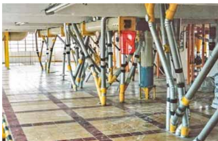
Ilustración 29.- Interior del cuerpo de cribado correspondiente al nivel 3. Archivo de Navarro Franco.
