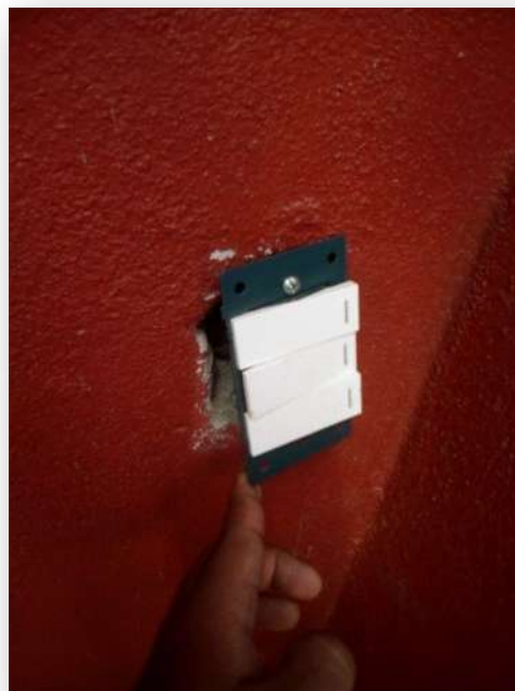
Fig. 23 Apagadores en mal estado. Fuente: imagen propia
