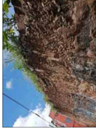
DETALLE DE DETERIORO EN FACHADA LATERAL
