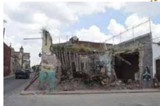
Ilustración 2 Samuel Herrera Jr. En el centro de Morelia hay decenas inmuebles en condiciones deplorables.
