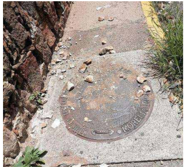
"Desprendimiento de cantera" Foto: VGEC
