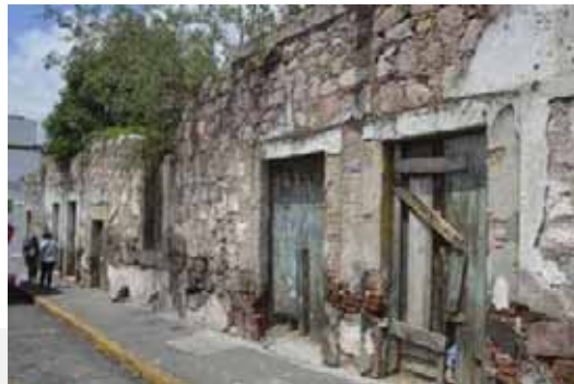
Ilustración 1 Samuel Hèrrera Jr. En el centro de Morelia hay decenas inmuebles en condiciones deplorables
