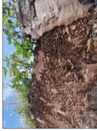
DETALLE DE DETERIORO EN FACHADA LATERAL
