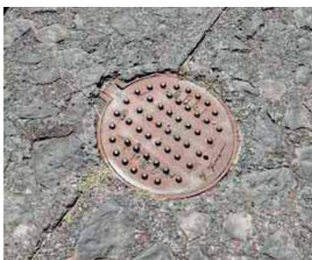
Imagen 35. Sistema de drenaje cerca del predio.
