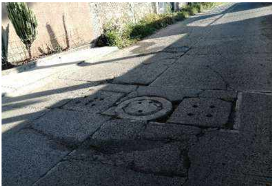
Foto 68. Coladeras sanitarias de concreto. 2021, Fuente: propia, Luis Eduardo Pérez Gallegos.
