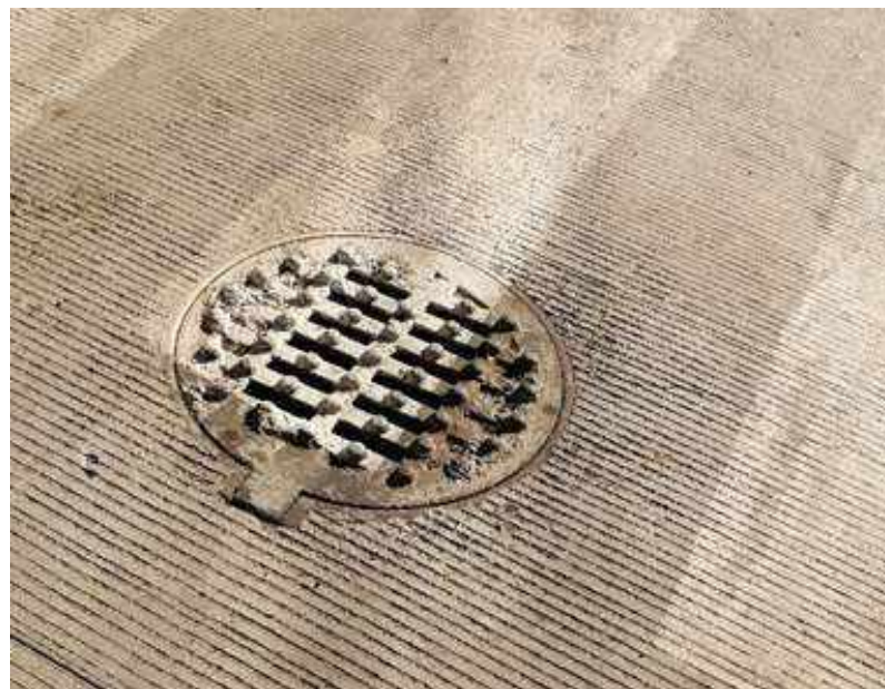
Foto 69. Coladeras sanitarias de metal. 2021, Fuente: propia, Luis Eduardo Pérez Gallegos.
