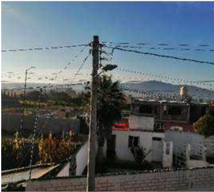
Foto 64. Poste de luz de concreto. 2021, Fuente: propia, Luis Eduardo Pérez Gallegos.
