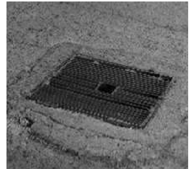
Foto 67. Compuerta de válvula de agua. 2021, Fuente: propia, Luis Eduardo Pérez Gallegos.
