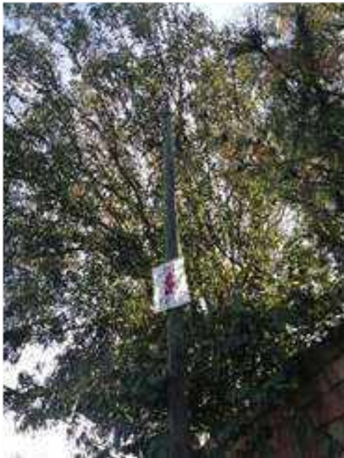
Foto 65. Poste de luz de madera. 2021, Fuente: propia, Luis Eduardo Pérez Gallegos.
