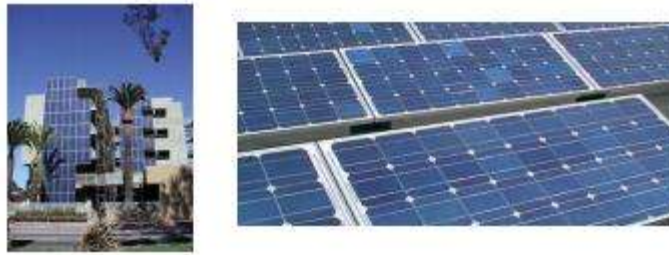
Figura 13 Ejemplo de paneles solares
