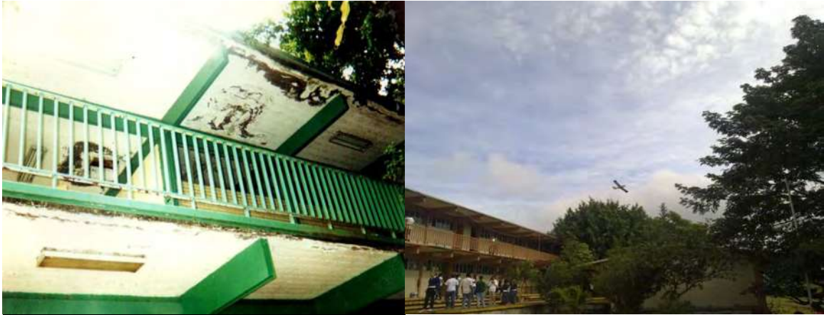
MUROS Y BARANDALES CON PINTURA DETERIORADA. UNA EXPLANADA CIVICA A LA QUE SE CONSTRUYÓ TECHO Y GRADAS PARA HABILITARLA COMO AUDITORIO
