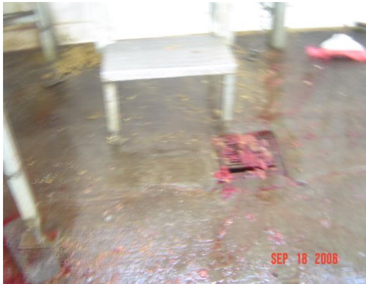
Imagen que muestra el inadecuado funcionamiento del drenaje con referencia a la pregunta no.10. (Huiramba)
