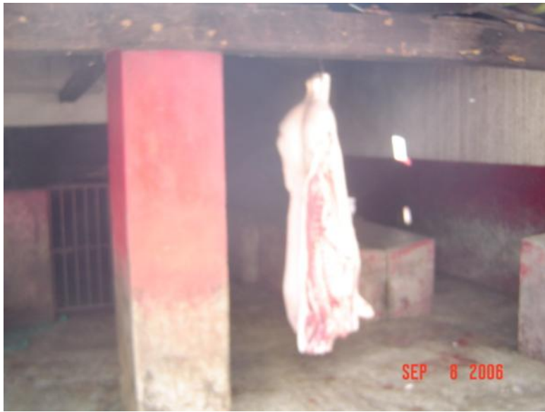
Imágenes que muestran la falta de rieles en el rastro referente a la pregunta no.8 (Lagunillas)
