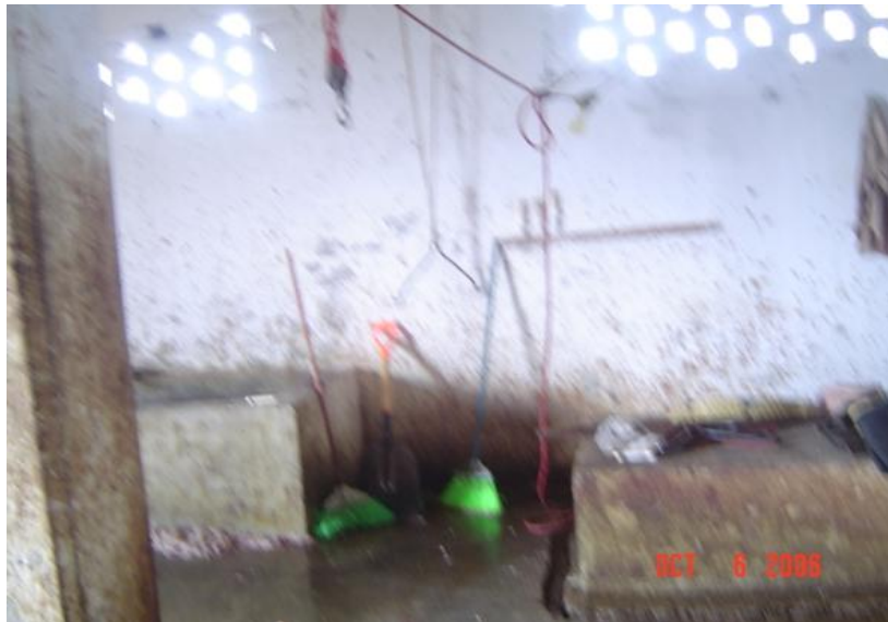
Imagen que nos muestra desorden en el material de aseo paredes y sucias en el municipio de (Copandaro)
