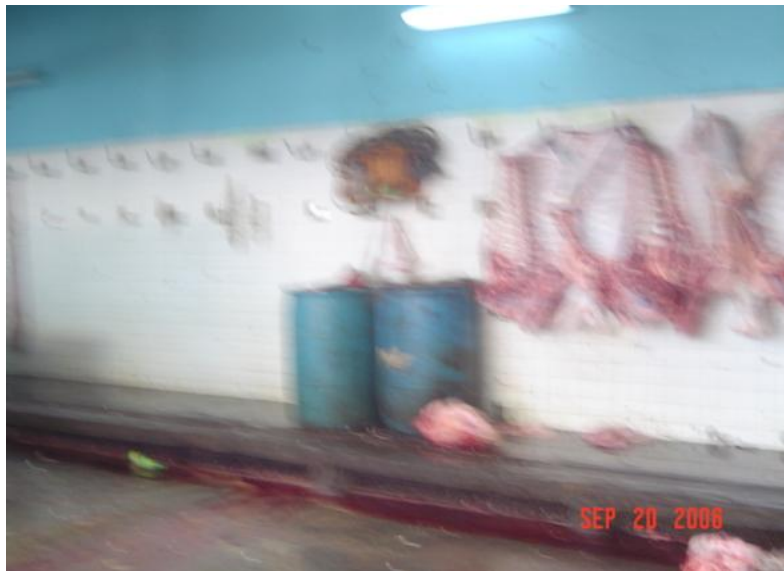
Imagen que nos muestra la falta de rieles de suspensión e inadecuado drenaje referente a la preguntas no. 8 y 10 (Zacapu).
