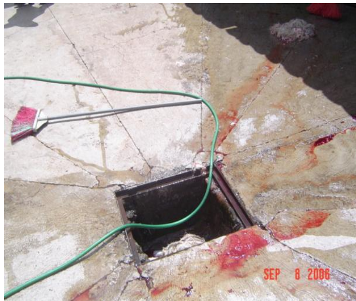
Imagen que muestra un inadecuado funcionamiento del drenaje referente a la pregunta no. 10 (Lagunillas)
