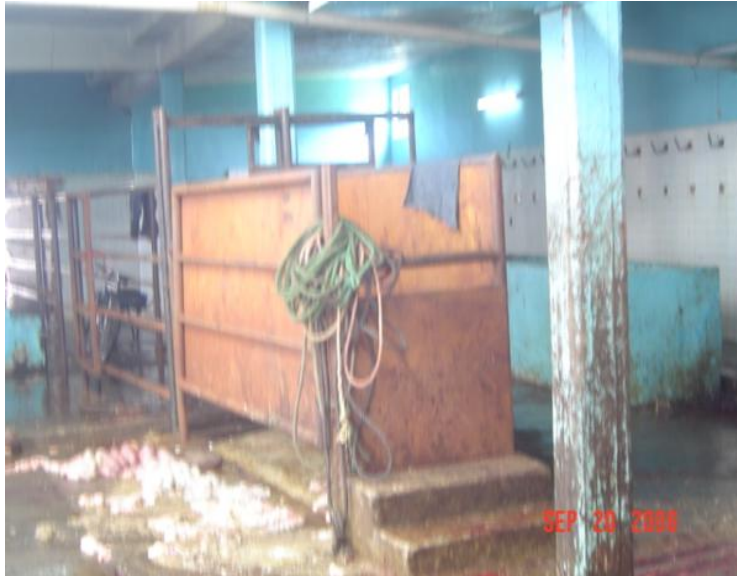
Imagen que muestra el mal uso del cajón de recepción e insensibilización ya que se observa al lado con contenido fecal, pelo etc., (Zacapu).
