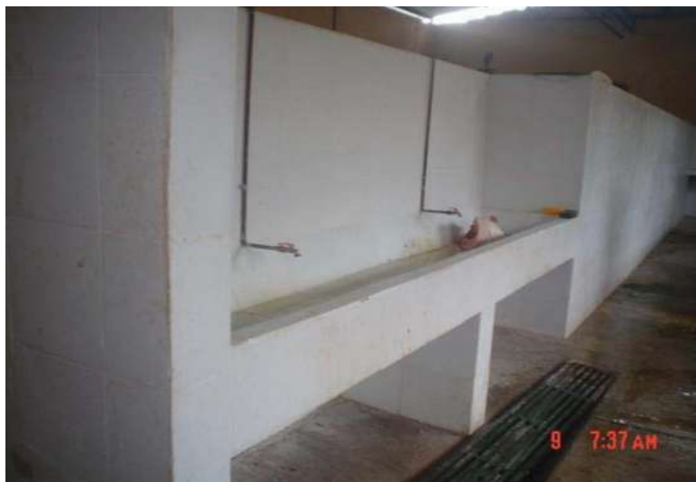
Foto 18: Lugar donde se depositan las cabezas de los animales, en la localidad de Tafetán, Tzitzio. Se puede observar que esos depósitos no son los adecuados según las normas oficiales.
