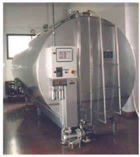
Fig. 7 Tanque de almacenamiento.
