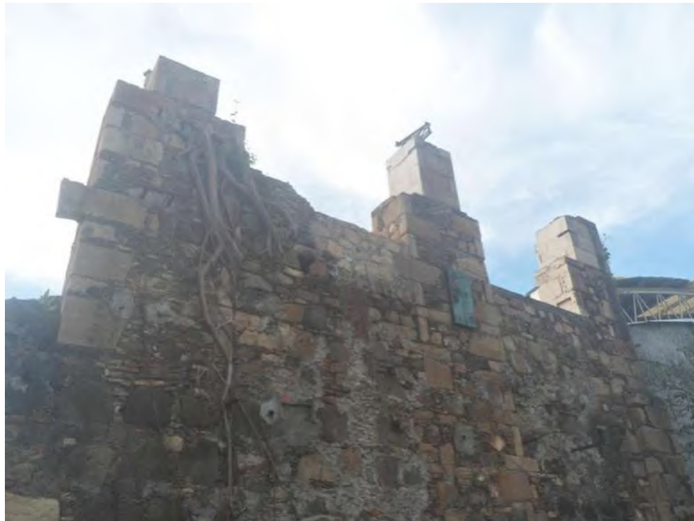
Muro exterior en la parte del ingenio, ya para este entonces casi todos los edificios han sido destruidos y la maquinaria desmantelada y transportada.
