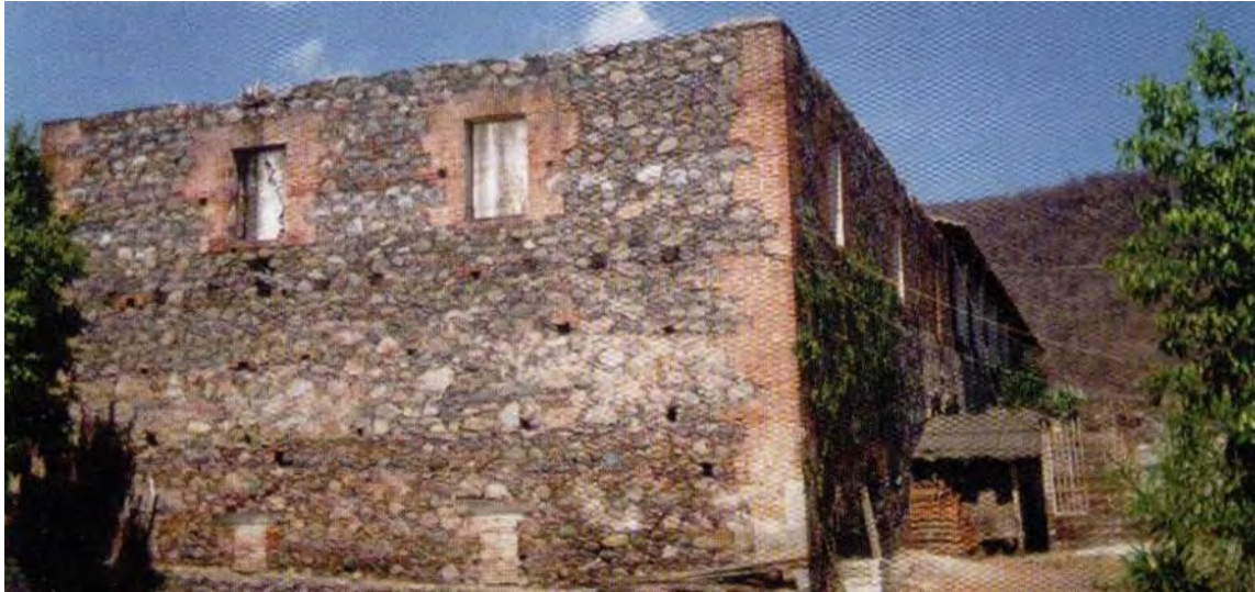
Muros exteriores del edificio principal, el techo ha colapsado debido al mal estado de las vigas de madera. Esta foto se tomó de Mercado Corona. Op. Cit. , p. 30.
