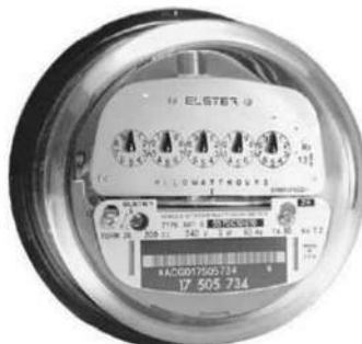
Imagen 9.1 medidor de energía eléctrica electromecánico
