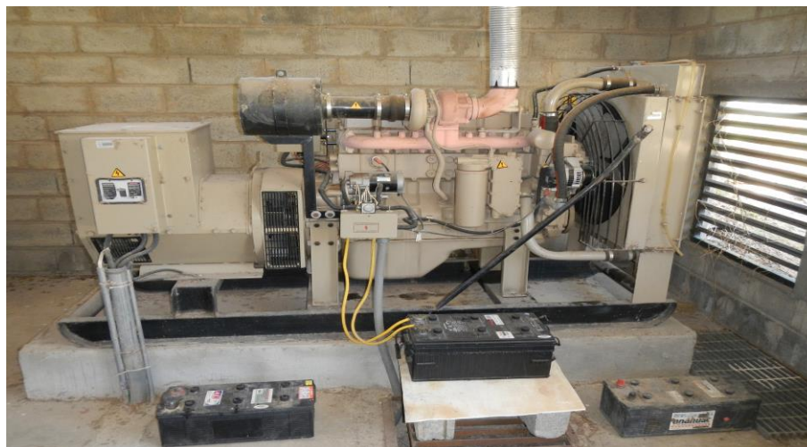
Figura 22 Cuarto de máquinas para llevar funciones de bombeo a los estanques.
