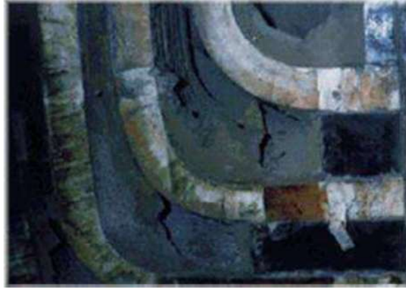
Figura 5.3.- Fotografía de contaminación en los cabezales del generador
