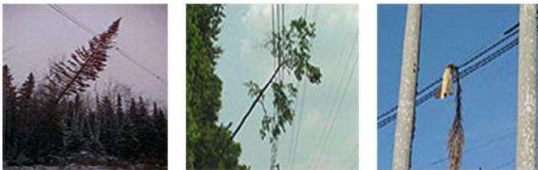
Figura 2.2.- Ramas y arboles sobre tendidos de red eléctrica compacta.
