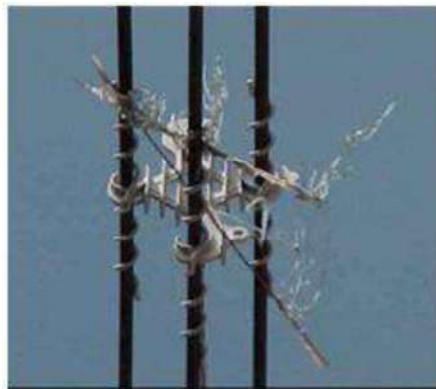
Figura 3.13.- Amarre de los conductores al espaciador mediante el preformado plástico.
