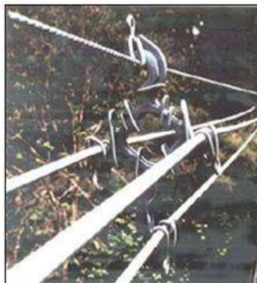
Figura 1.3.- Línea de distribución en M.T. (13.2 kV) tipo compacta.
