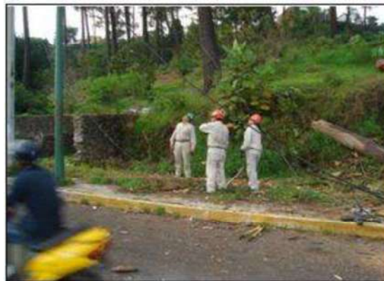
Figura 3.46.- Falla en línea compacta ocasionada por caída de árbol.
