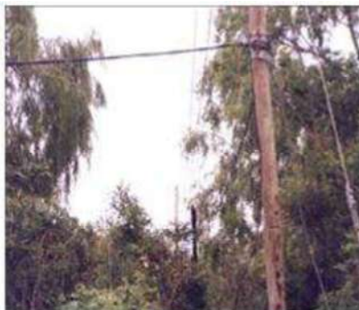
Figura 3.49.- Red eléctrica en zona con gran incursión de aves.
