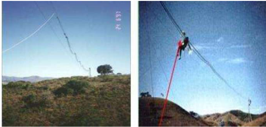
Figura 4.6.- Dificultad para utilizar canasta en barrancas para la colocación de los espaciadores.
