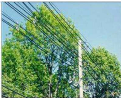
Figura 2.4.- Zona demasiado arbolada, junto a red eléctrica de distribución.
