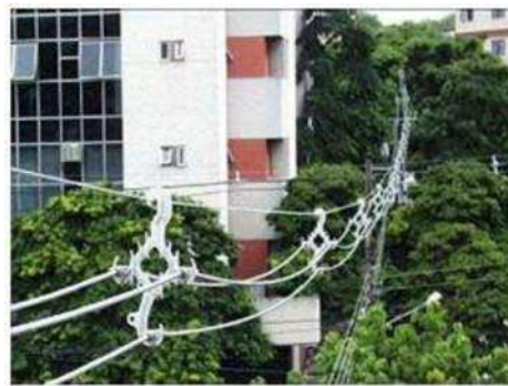
Figura 3.52.- Red eléctrica cercana a las edificaciones.
