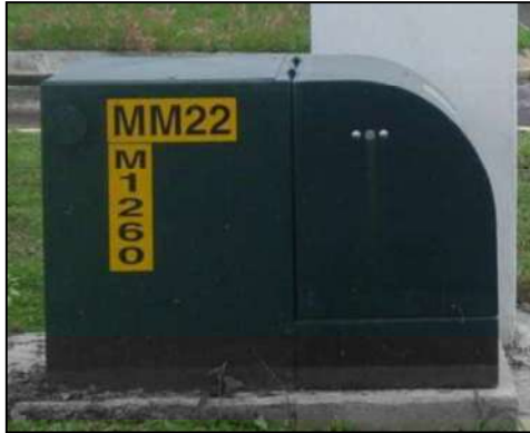
Fig. 2.3 Transformador tipo pedestal
