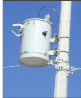
Fig. 2.4 Transformador tipo poste
