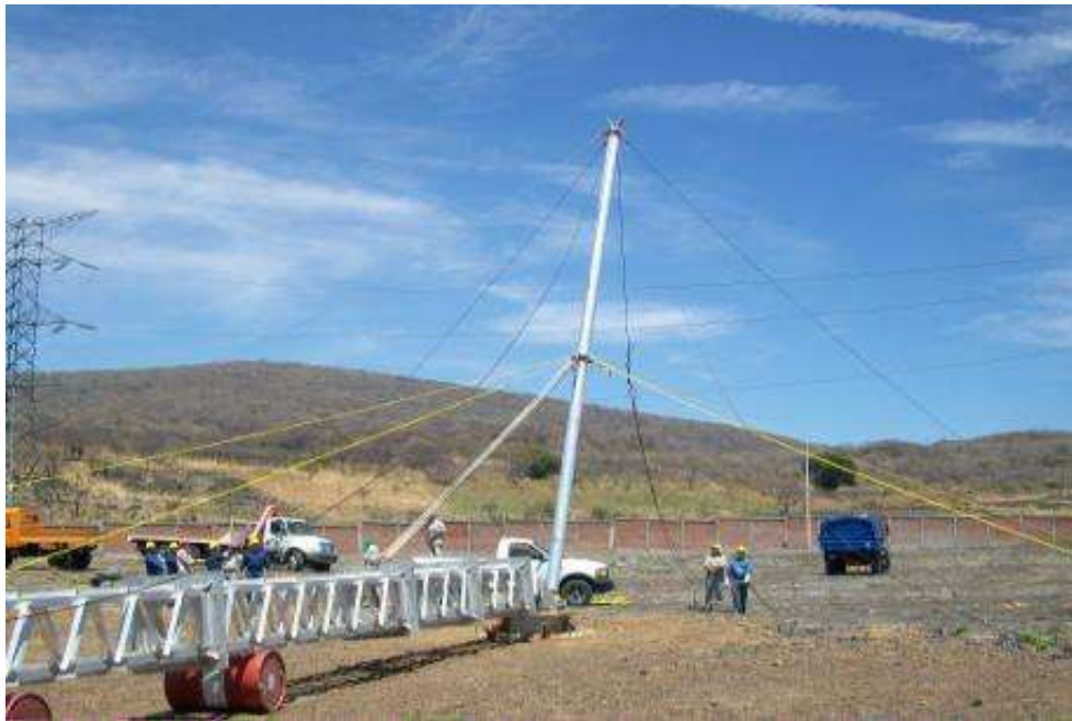
Figura 5.5 Estructura pivoteada sobre su base con pluma en piso
