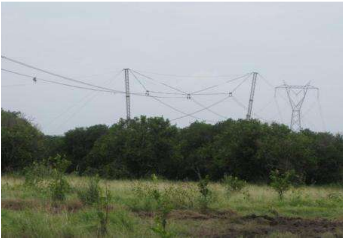
Figura 5.10 Estructura tipo Chainette instalada
