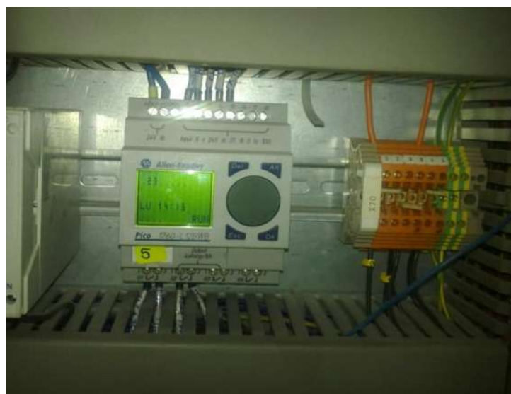
Figura 4.9 PLC instalado en la aplicación.
