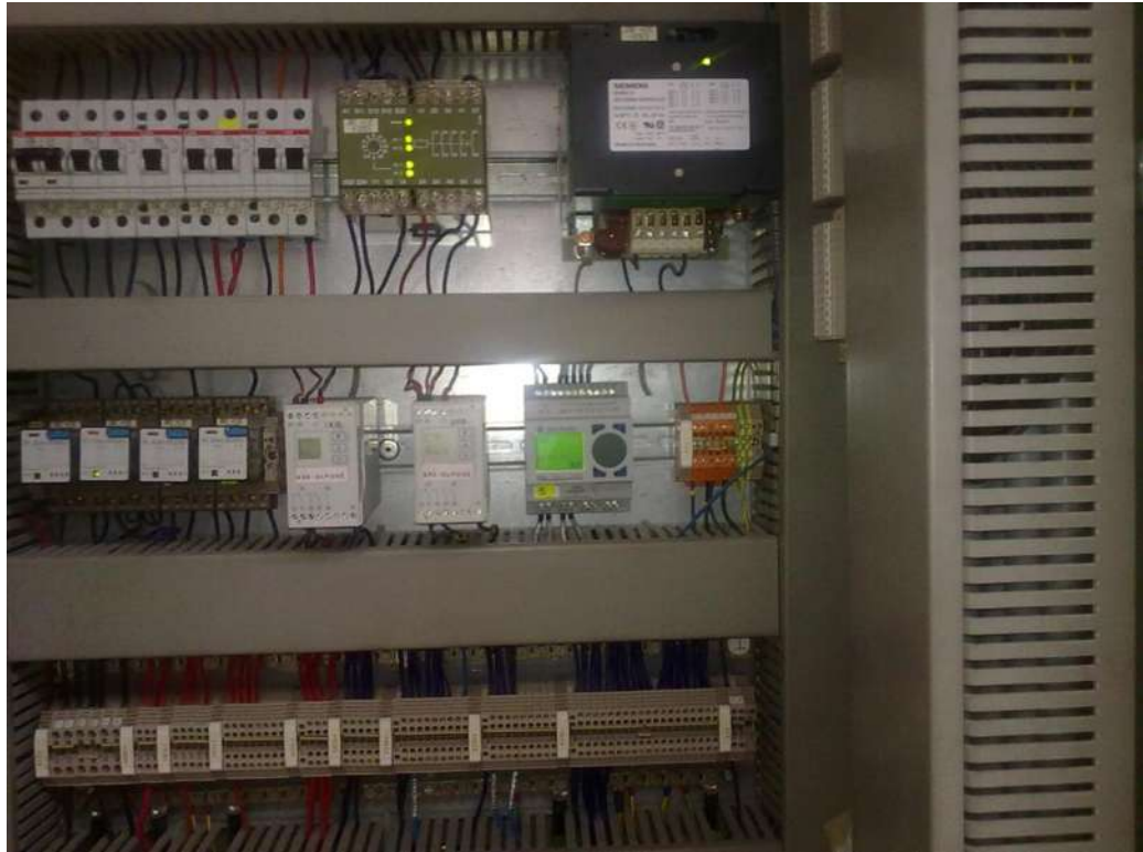
Figura 4.10 PLC instalado en la aplicación.
