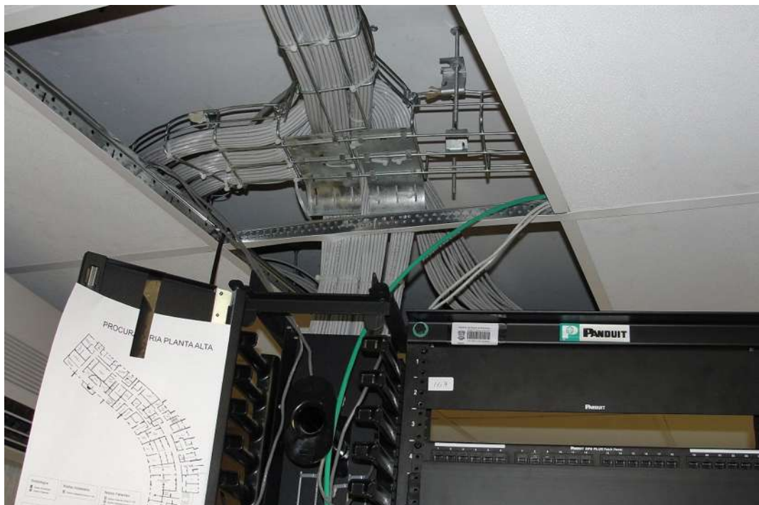
Figura 4.10. Concentración de escalerilla y bajada de cables hacia el Rack.
