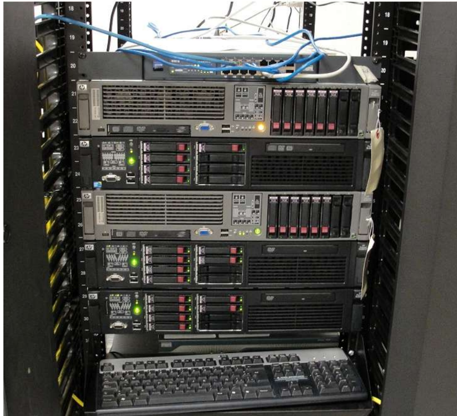
Figura 4.5. Servidores montados en el rack del Site de la DPIE.
