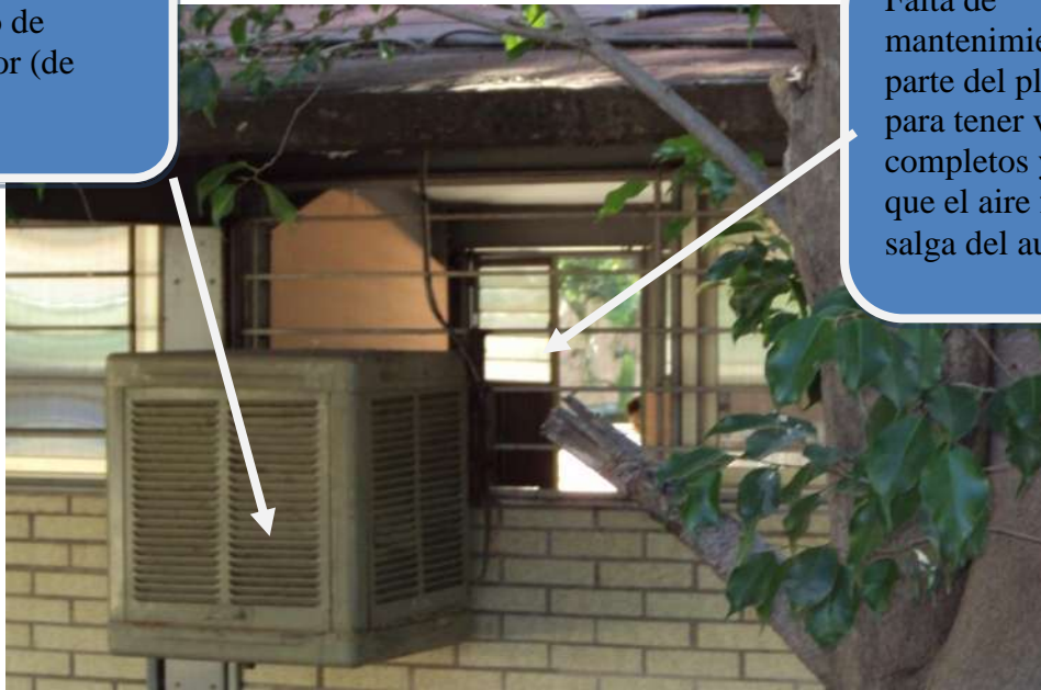
Fig.3.1.5 Sistemas de aire acondicionado antiguo y falta de cultura por no tener vidrios para aislar el ambiente.
