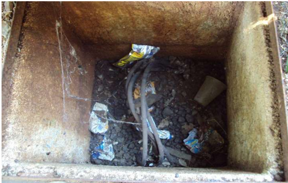
Fig.3.2.2 Condiciones del primer registro y sin varilla de tierra
