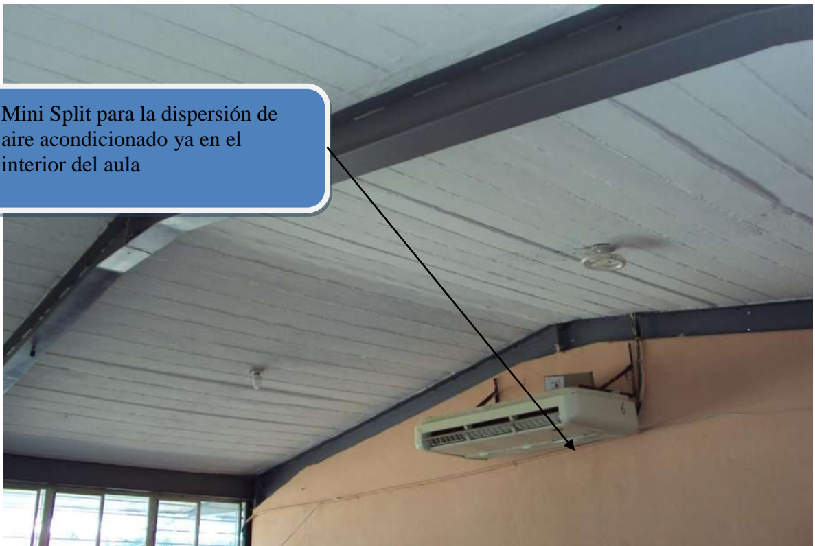
Fig. 3.1.4 Mini Split instalado en el interior de las aulas
