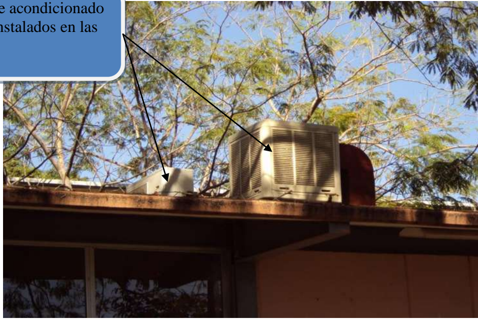
Fig.3.1.3 Sistemas de aire acondicionado instalado en las azoteas de las aulas
