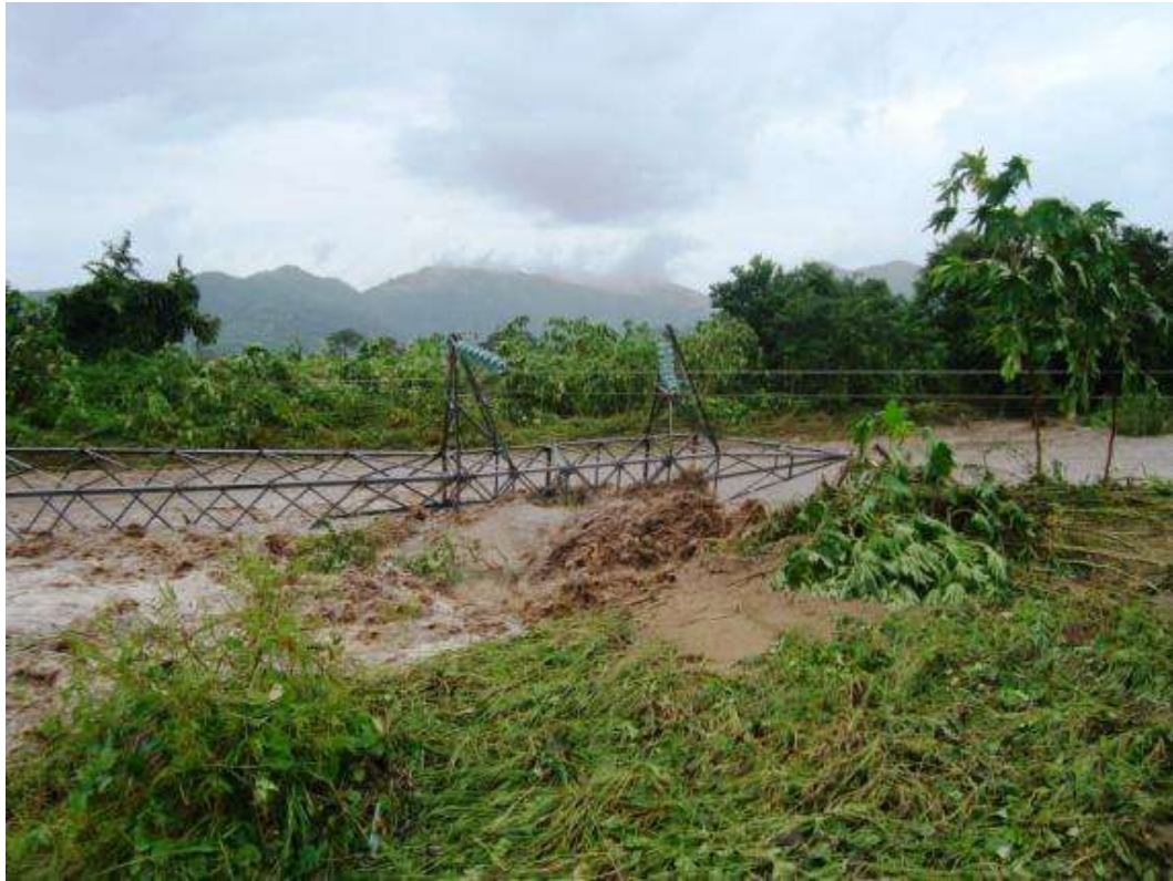
Figura 4.2 Estructura colapsada por efectos del huracán JOVA.
