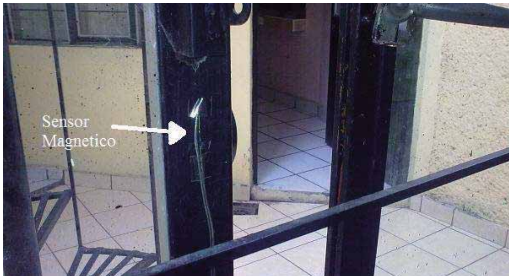
Fig. 5.1 Sensor magnético colocado en la ventana.
