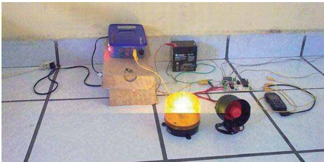
Fig. 5.9 Alarma activada con la apertura de puerta.
