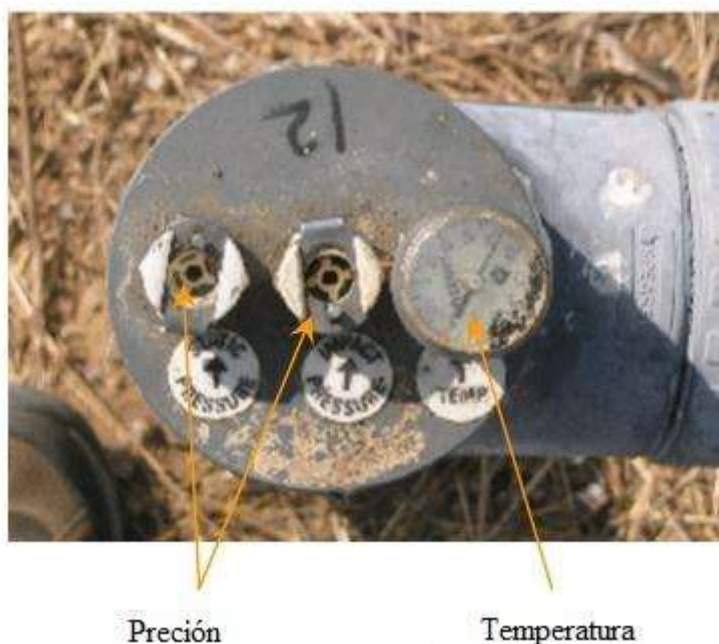
Figura 4-4 Cabezal del pozo de extracción.
