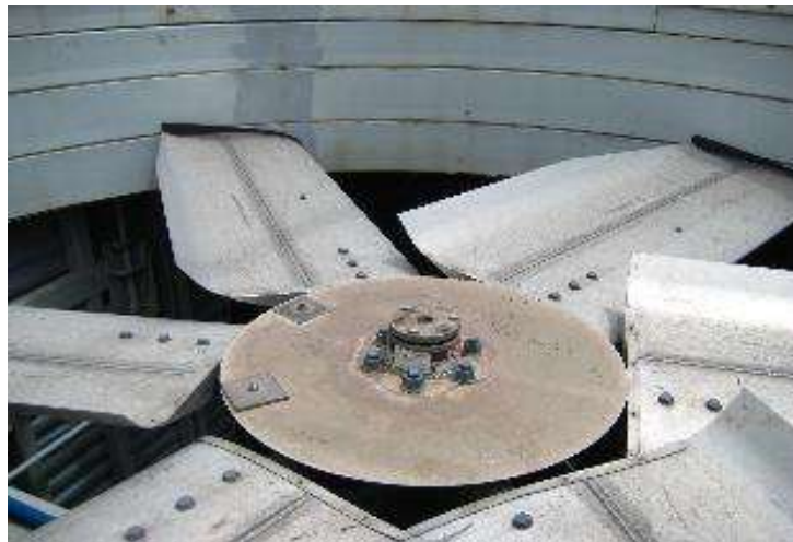
Figura 3.8 Ventilador de una torre de refrigeración tiro inducido.
