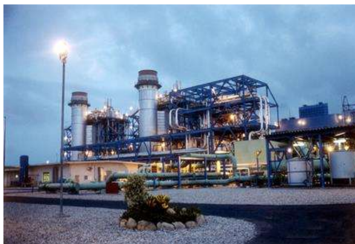
Figura 2.2 Central termoeléctrica “Altamira”, ubicada en Altamira, Tamaulipas, tomada en 2003.
