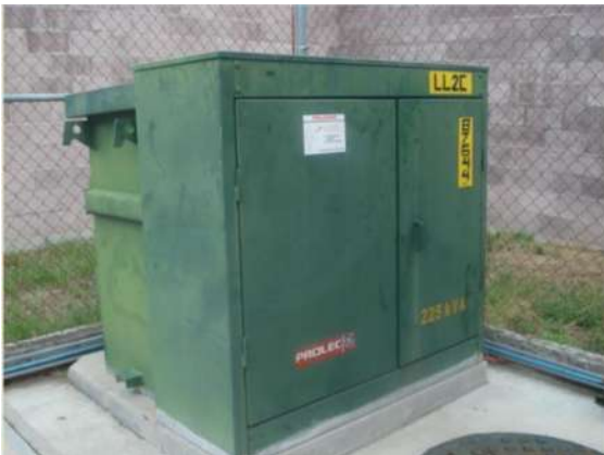
Figura 4.8 Transformador de 225 kVA
