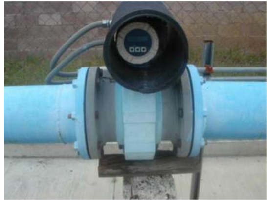
Figura 4.11. Medidor de flujo de agua.
