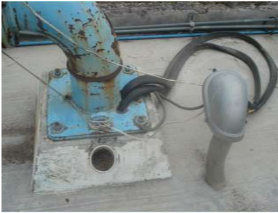
Figura 4.5. Alimentación eléctrica de la bomba de extracción.
