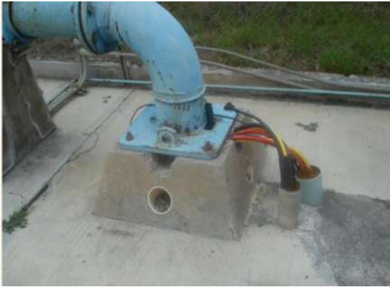
Figura 4.10. Alimentación de la bomba de extracción.
