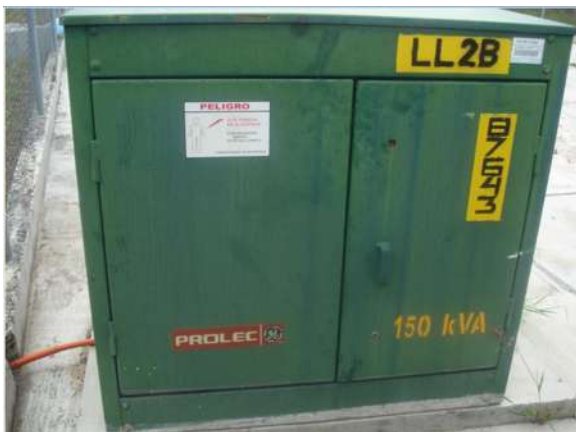
Figura 4.3 Transformador de 150 kVA
