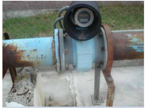
Figura 4.6. Medidor de flujo de agua.
