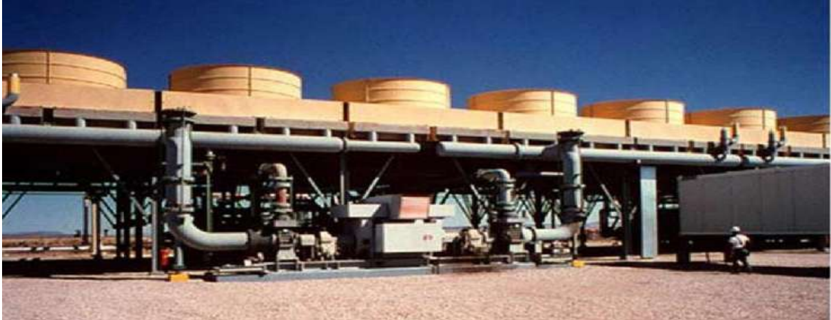
Figura 2. 9 Central geotérmica de Soda Lake (Nevada).
