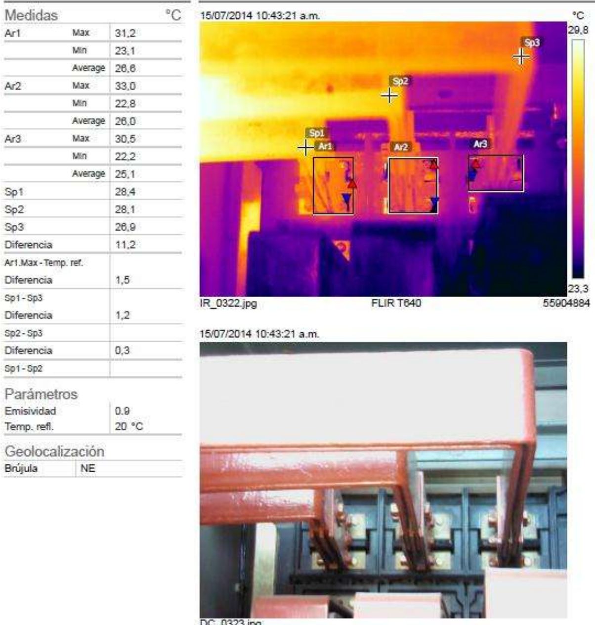
Figura 4.38 Reporte termográfico sintetizado de un interruptor de potencia de la S.E 8H
