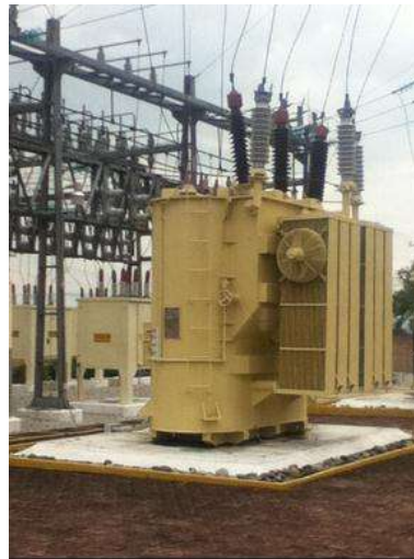
Figura 4.4 Subestación receptora (reductora) secundaria
