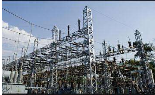
Figura 4.3 Subestación receptora (reductora) primaria
