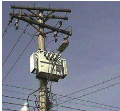
Figura 4.6 Subestaciones de distribución tipo intemperie
