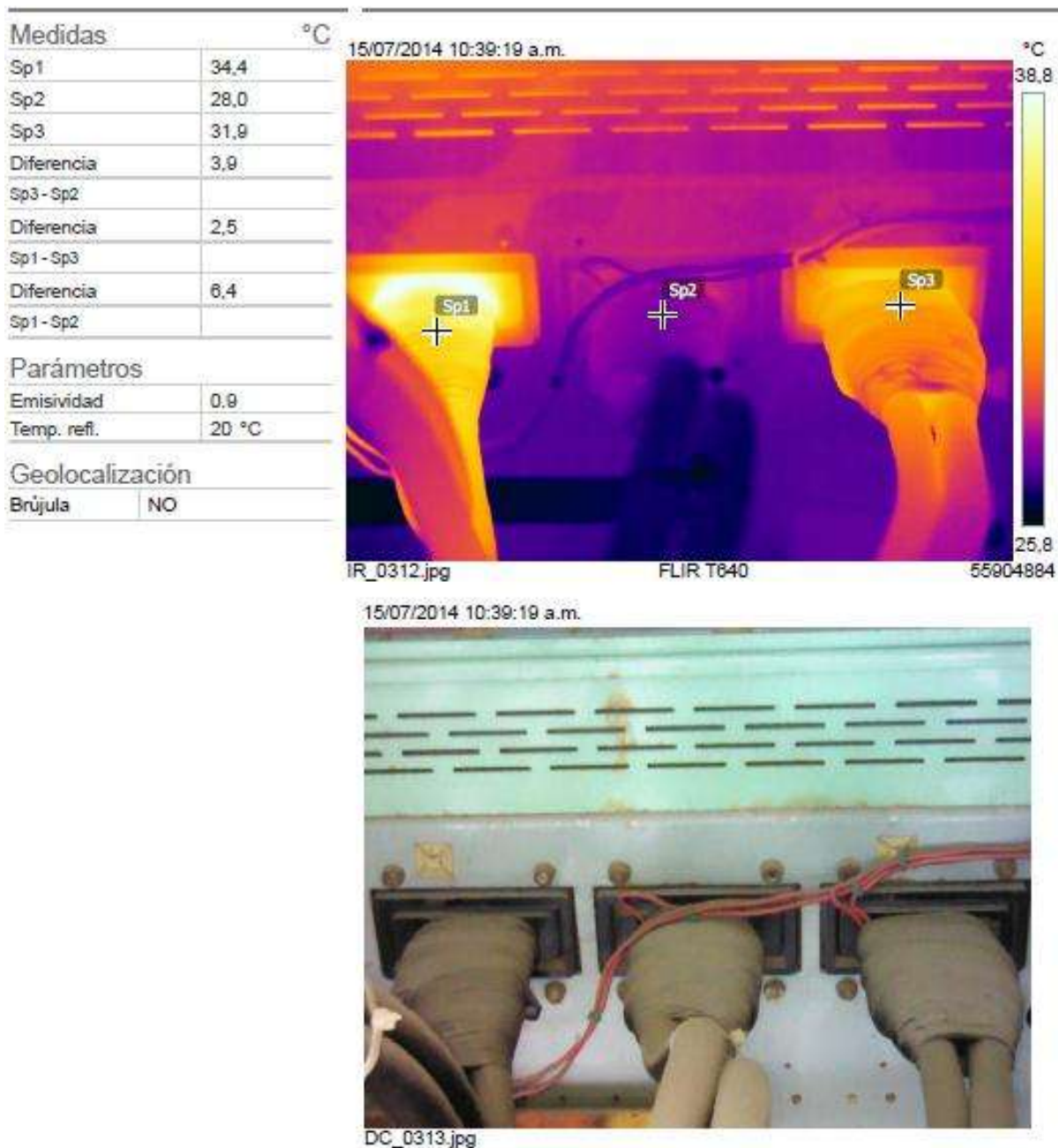
Figura 4.37 Reporte termográfico sintetizado de un interruptor de potencia de la S.E 7H
