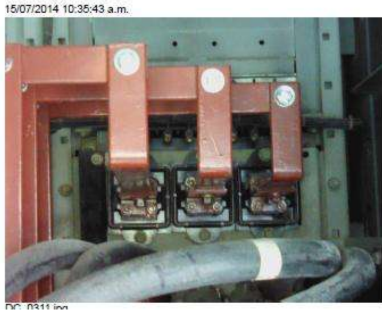
Figura 4.36 Reporte termográfico sintetizado de un interruptor de potencia de la S.E 1L
