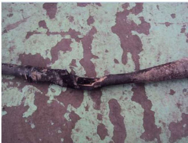
Figura 4.39 Destrucción del empalme
