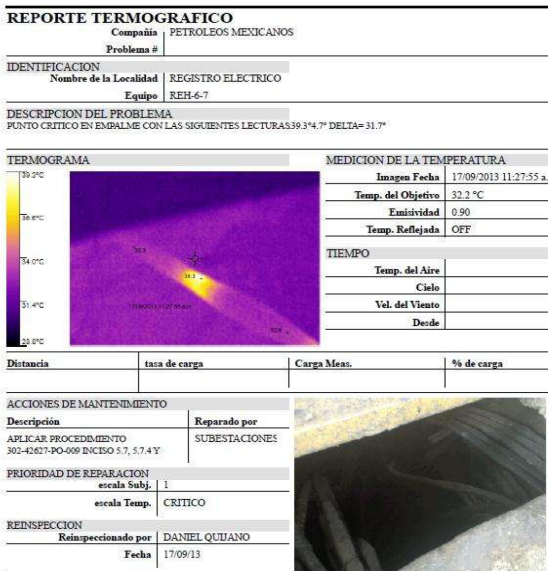
Figura 4.35 Reporte termográfico sintetizado de un empalme en REH-6-7
