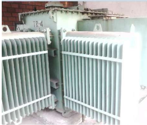
Figura 4.10 Transformador de potencia
