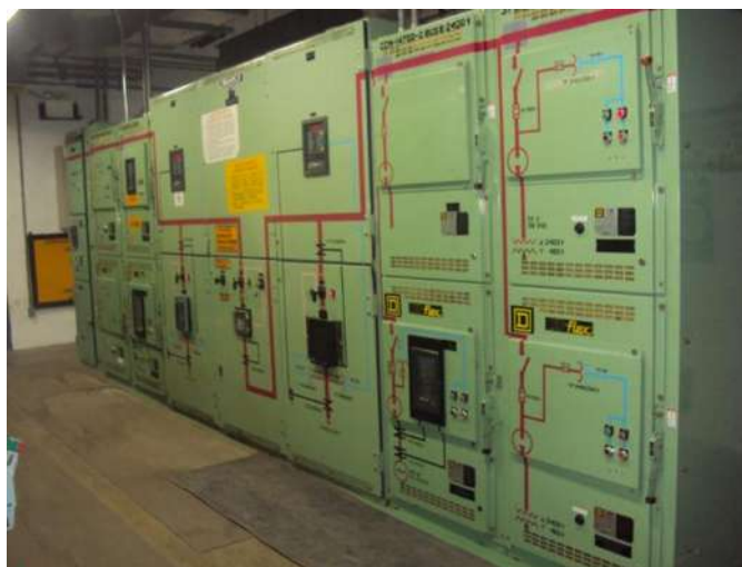
Figura 4.7 Subestación compacta tipo interior
