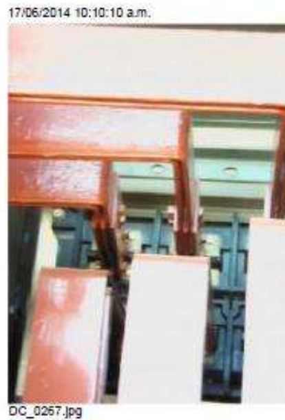
Figura 4.33 Reporte termográfico sintetizado de un interruptor de potencia de la S.E 8H
