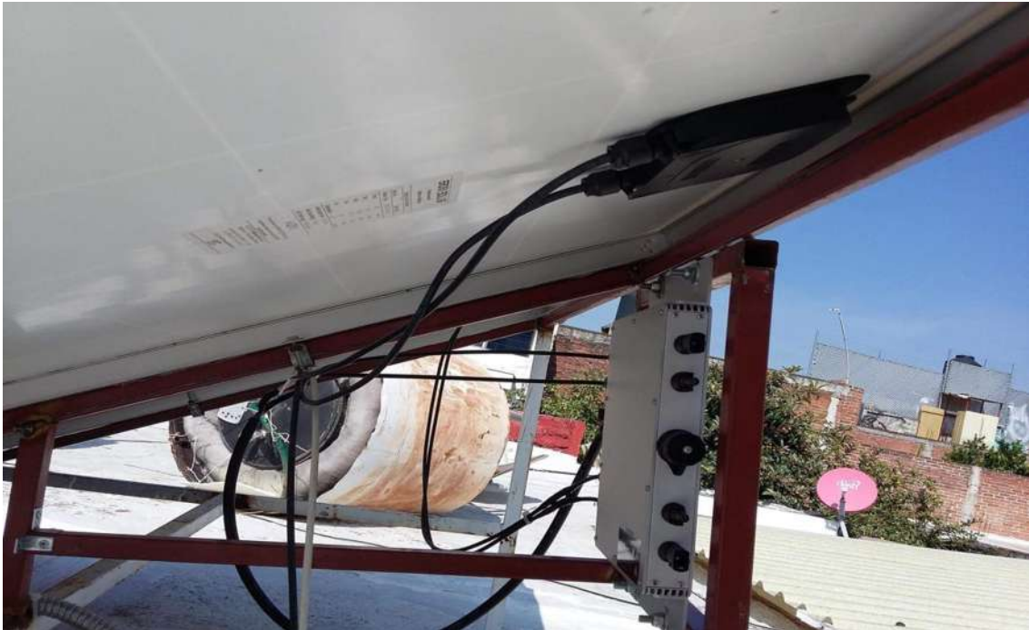
Figura 4. 11 Vista lateral inferior en donde se muestra la estructura y el inversor que conforman el sistema de 500W para caso de estudio 2.
