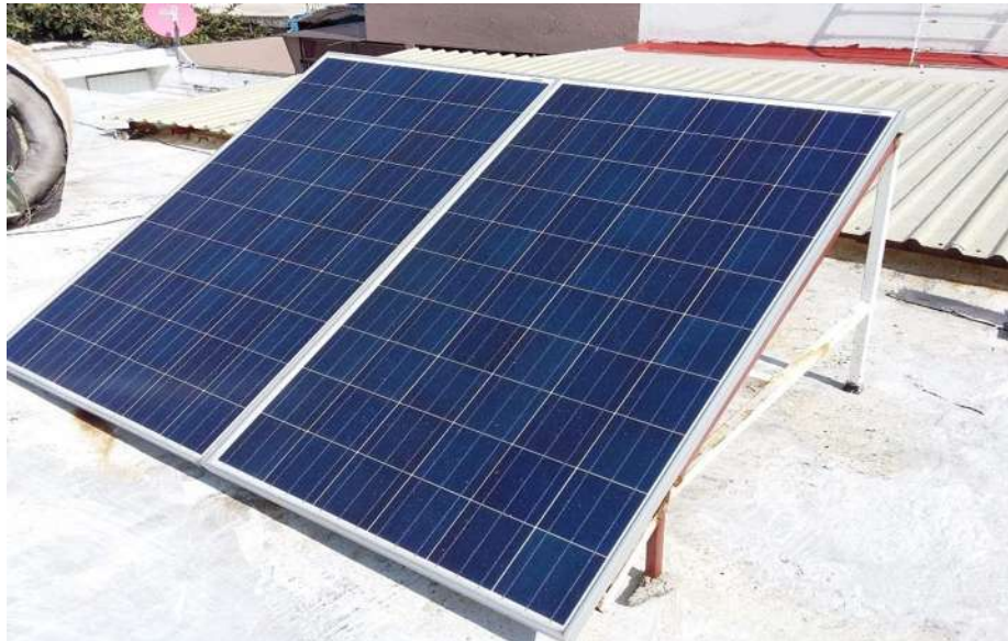
Figura 4. 10 Paneles solares que conforman el sistema de 500W para caso de estudio 2.
