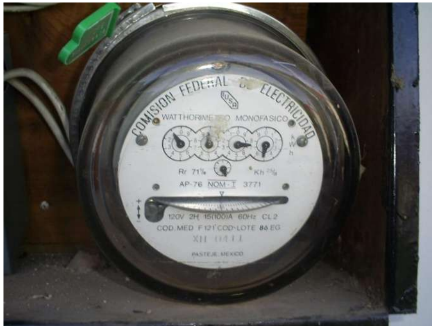
Figura 2. 22 Watthorímetro monofásico analógico utilizado por CFE.
