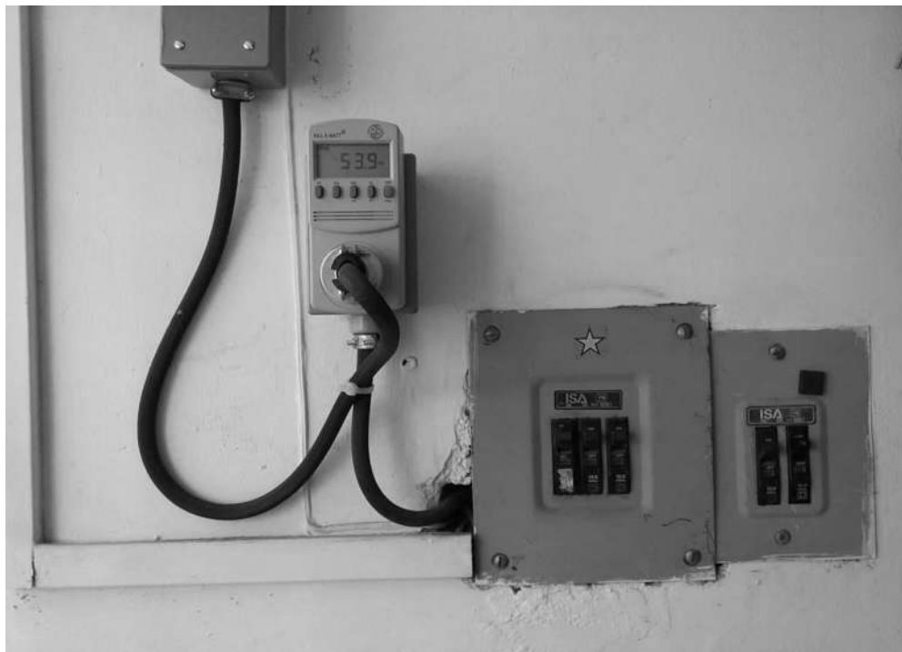
Figura 4. 12 Medidor de energía local e interruptores termomagnéticos que conforman el sistema de 500W para caso de estudio 2.
