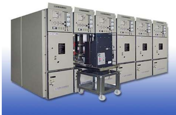
Figura 11.- Tablero de distribución de media tensión.
