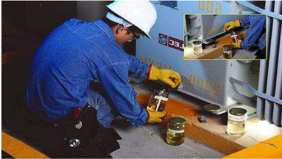
Figura 24.- Extracción de aceite a un transformador para realizar la prueba de Rigidez Dieléctrica.
