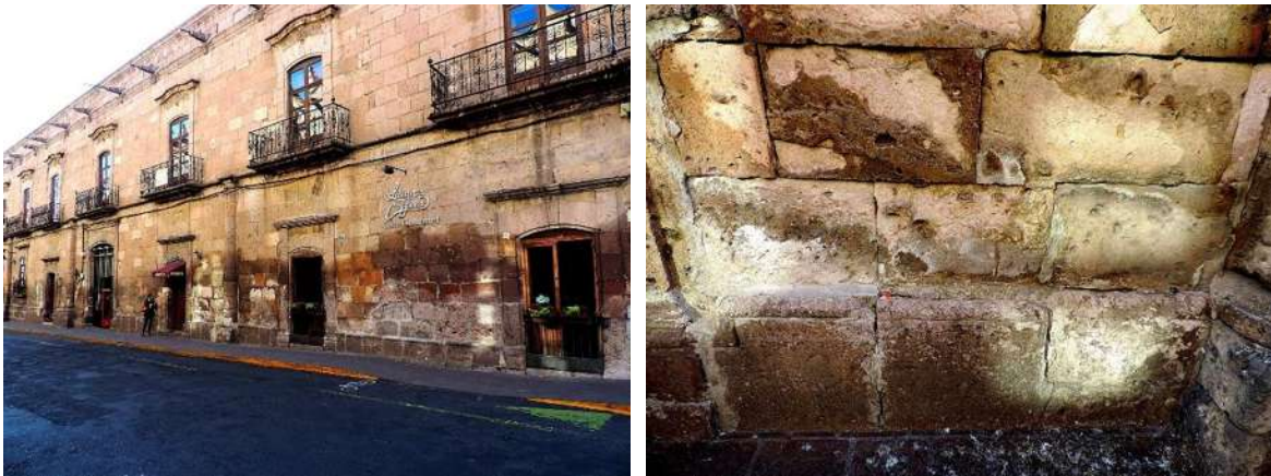
Fig. 14. Estado actual de la ignimbrita en fachada principal de inmueble ubicado en la calle Galeana, Colonia Centro, Morelia, Michoacán, México. Fuente: Aldo Zamudio Pérez, 2015.
