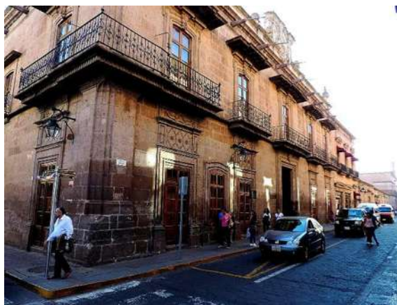
Fig. 17. Humedad constante de la ignimbrita en fachada principal de inmueble ubicado en calle Allende, Colonia Centro, Morelia, Michoacán, México. Fuente Aldo Zamudio Pérez, 2015.
