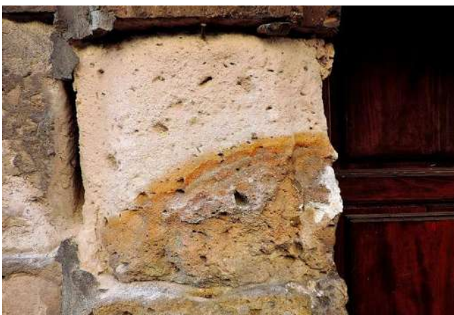
Fig. 07. Deterioro de ignimbrita en fachada principal de inmueble ubicado en calle Galeana, Colonia Centro, Morelia, Michoacán, Mx. Fotografía Aldo Zamudio Pérez, 2016.
