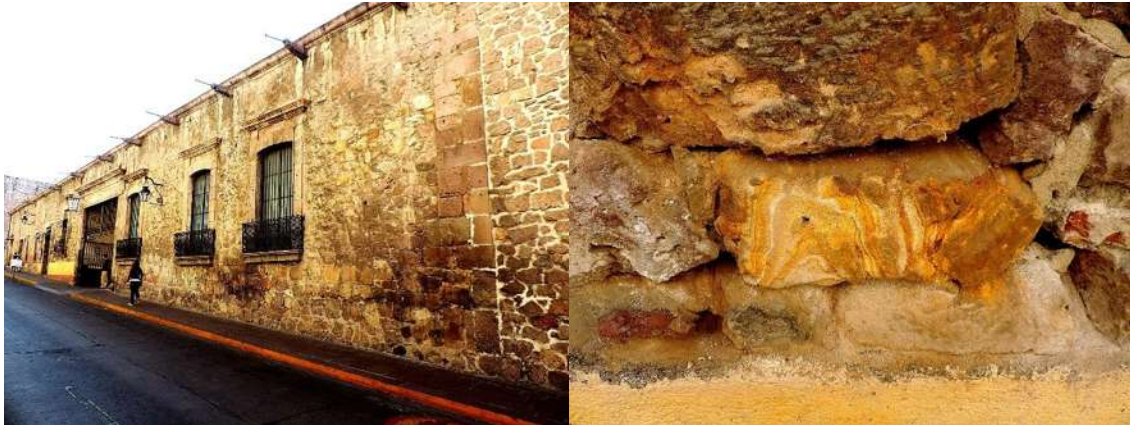
Fig. 06. Deterioro de ignimbrita en fachada principal de inmueble ubicado en calle Guillermo Prieto, Colonia Centro, Morelia, Michoacán, Mx. Fotografía Aldo Zamudio Pérez, 2016.
