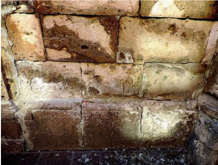
Fig. 23. Cristalización de sales en ignimbrita, inmueble ubicado en calle Galeana, Morelia, Michoacán, México. Fuente: Aldo Zamudio Pérez, 2015.
