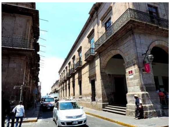
Fig. 16. Humedad constante de la ignimbrita en fachada principal de inmueble ubicado en calle Allende, Colonia Centro, Morelia, Michoacán, México. Fuente: Aldo Zamudio Pérez, 2015.
