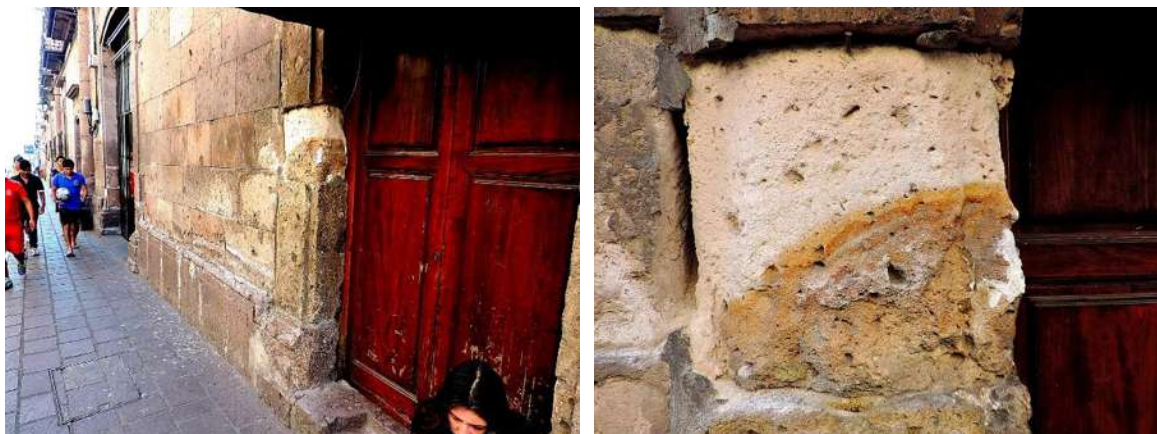
Fig. 22. Cristalización de sales en jamba de ignimbrita, inmueble ubicado en calle Galeana, Morelia, Michoacán, México. Fuente: Aldo Zamudio Pérez, 2017.
