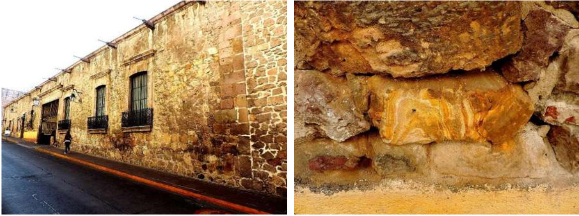
Fig. 13. Estado actual de la ignimbrita en fachada principal de inmueble ubicado en la calle Guillermo Prieto, Colonia Centro, Morelia, Michoacán, México. Fuente: Aldo Zamudio Pérez, 2015.
