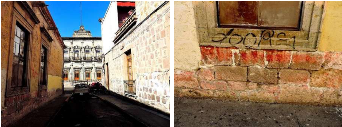
Fig. 11. Estado actual de la ignimbrita en fachada principal de inmueble ubicado en la calle Fray Manuel Navarrete, Colonia Centro, Morelia, Michoacán, México. Fuente: Aldo Zamudio Pérez, 2015.
