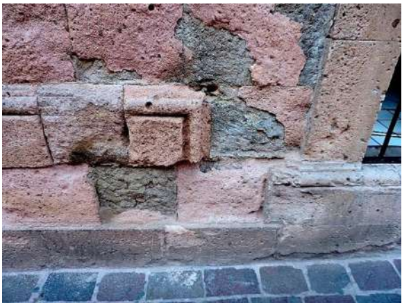
Fig. 18. Disgregación sacaroidea en ignimbrita de inmueble ubicado en Av. Morelos Norte, Morelia, Michoacán, México. Fuente: Aldo Zamudio Pérez, 2017.
