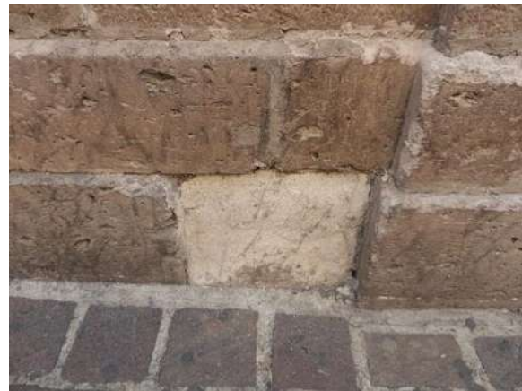
Fig. 19. Exfoliación en la ignimbrita de inmueble ubicado en calle Abasolo, Morelia, Michoacán, México. Fuente: Aldo Zamudio Pérez, 2017.
