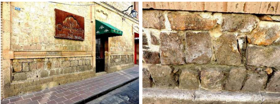
Fig. 12. Estado actual de la ignimbrita en fachada principal de inmueble ubicado en la Av. Morelos Norte, Colonia Centro, Morelia, Michoacán, México. Fuente: Aldo Zamudio Pérez, 2015.
