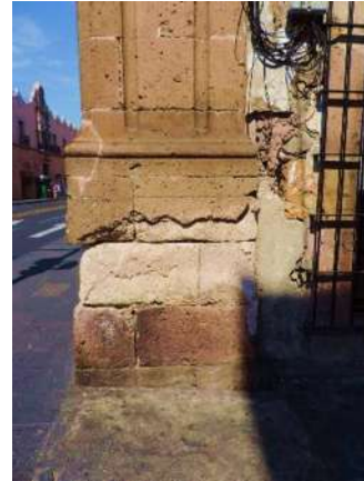
Fig. 21. Deslaminación en la ignimbrita de inmueble ubicado en calle Álvaro Obregón, Morelia, Michoacán, México. Fuente: Aldo Zamudio Pérez, 2017.
