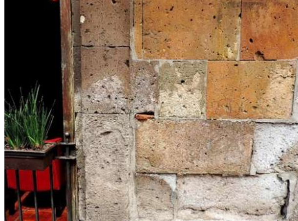
Fig. 08. Deterioro de la ignimbrita en fachada principal de inmueble ubicado en calle Galeana, Colonia Centro, Morelia, Michoacán, Mx. Fotografía Aldo Zamudio Pérez, 2015.
