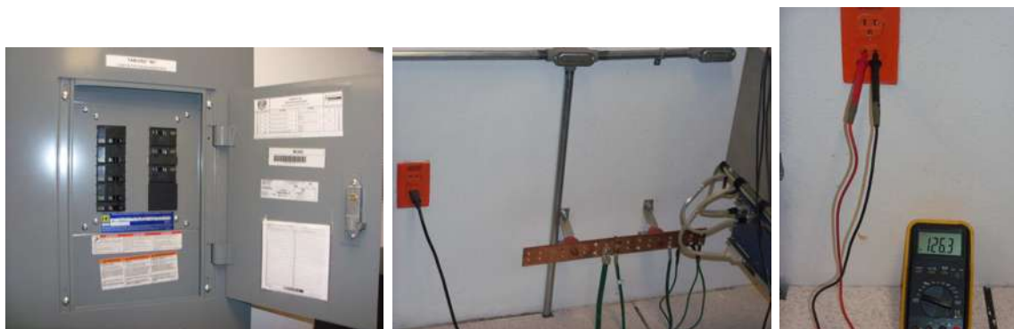
(a) Interruptores termomagnéticos
