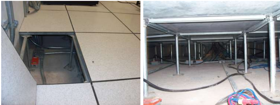
(a) Piso Elevado
