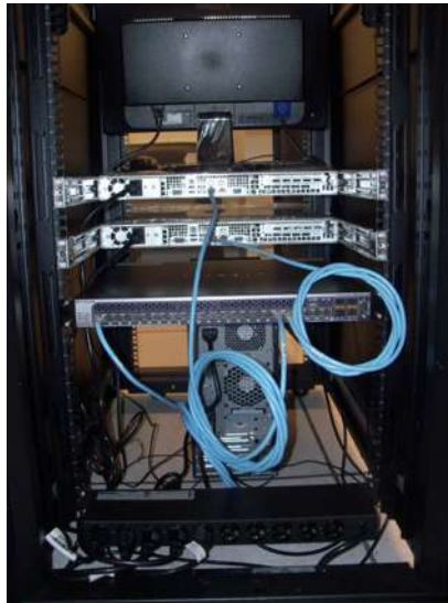
Figura 2.7: Montaje en rack (atrás)
