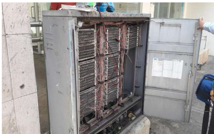
FIGURA 3.- Caja de distribución o Distrito
