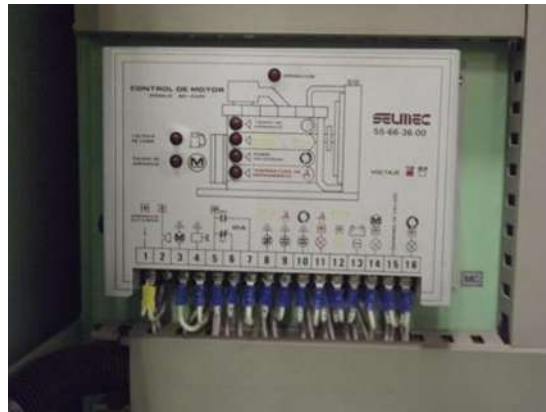
Figura 12.- Tablero de Control Electrónico
