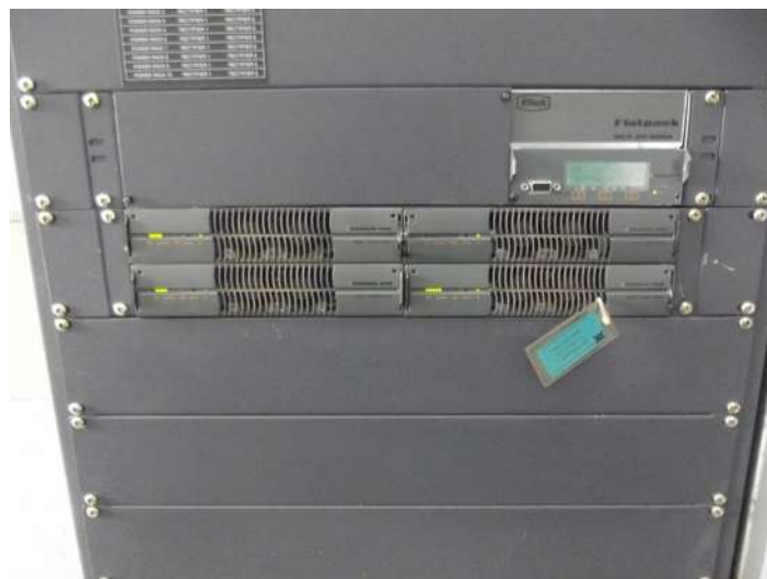
Figura 20.- Bastidor de Rectificadores 1800 Watts
