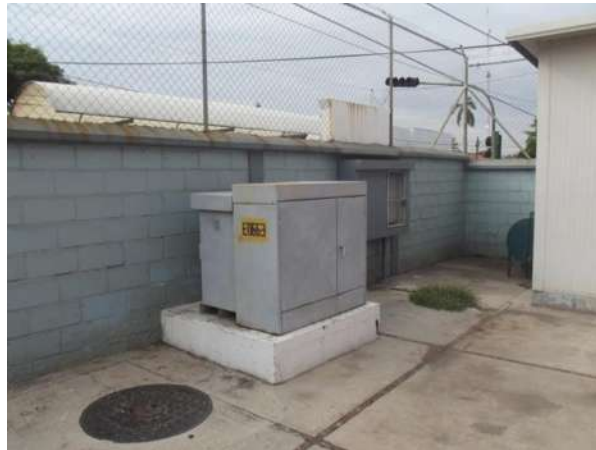
Figura 4.- De Pedestal 30 Kva
