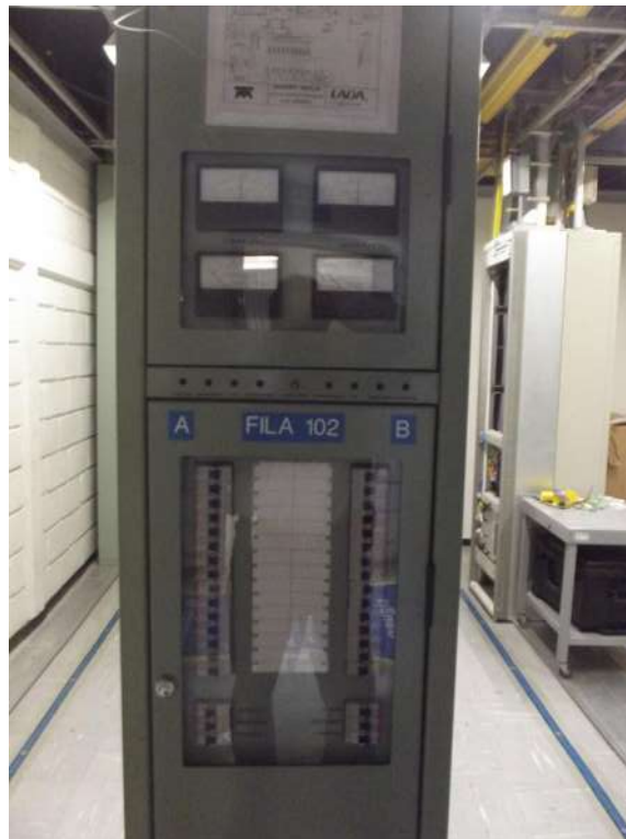
Figura 26.- Gabinete Lateral de Tensión
