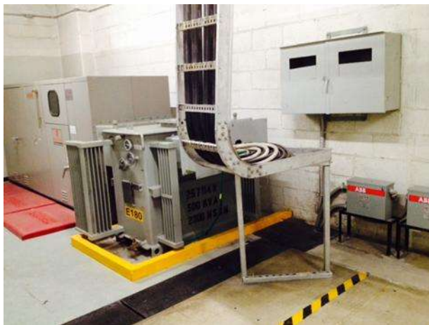
Figura 2.- Compacta Interior 500 Kva
