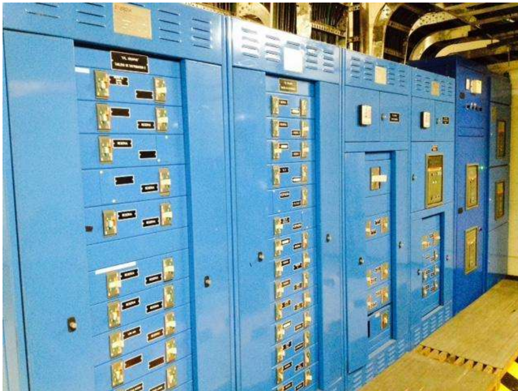
Figura 18.- Tableros de Distribución de Ca
