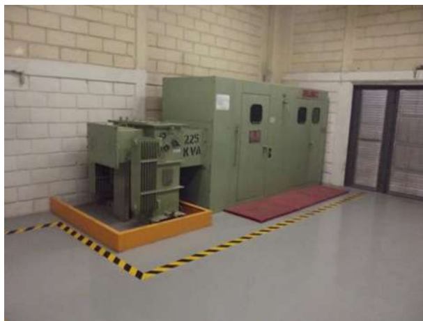
Figura 1.- Subestación Compacta Interior 225 Kva
