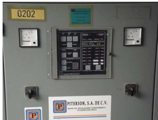
Figura 13.- Tablero de Control con Microprocesador
