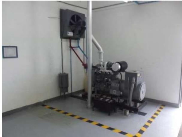
Figura 5.- Ge 50 KVA con Televent
