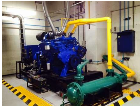
Figura 6.- Ge 600 KVA con Intercambiador de Calor
