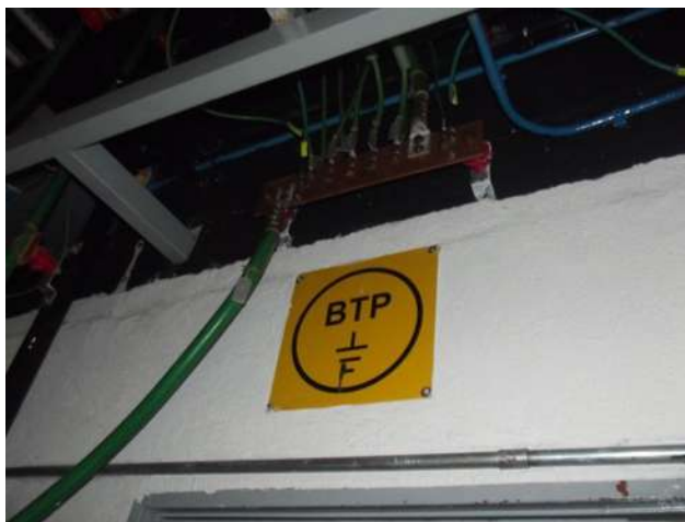
Figura 33.- Barra de Tierra de Piso
