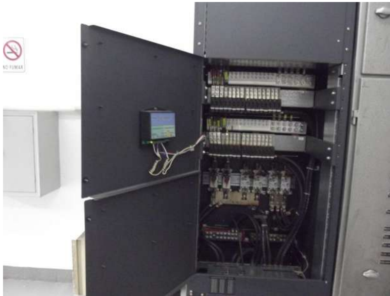
Figura 23.- Tablero de Distribución de CD
