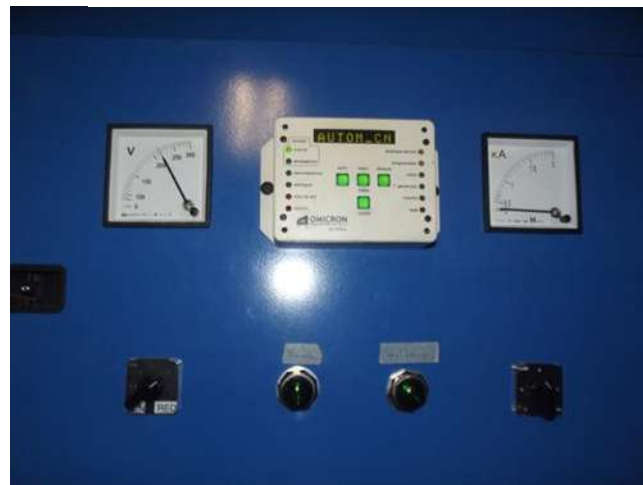
Figura 14.- Tablero de Control con Microprocesador
