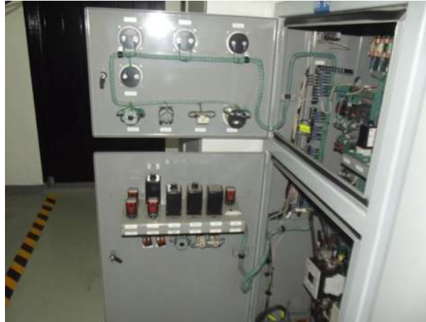
Figura 11.- Tablero de Control Electromecánico
