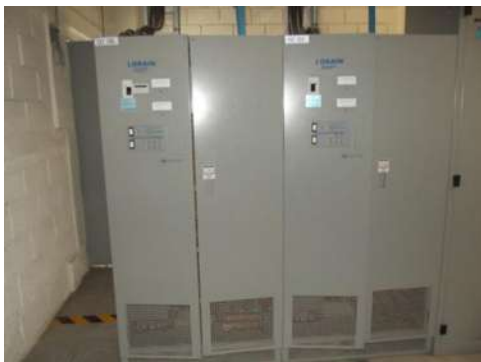
Figura 28.- Inversores 10 KVA Configuración 1:1
