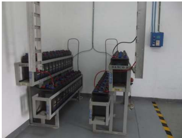
Figura 21.- Baterías Húmedas 360 A-H
