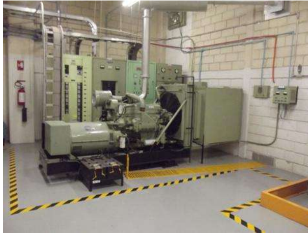
Figura 7.- GE 150 KVA Radiador en Patin
