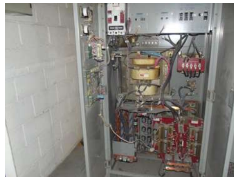
Figura 29.- Interior de Inversor 10 KVA
