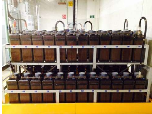
Figura 22.- Baterías Húmedas 1000 A-H
