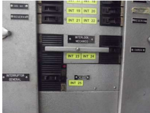
Figura 19.- Tablero de Distribución de CA con Interlock
