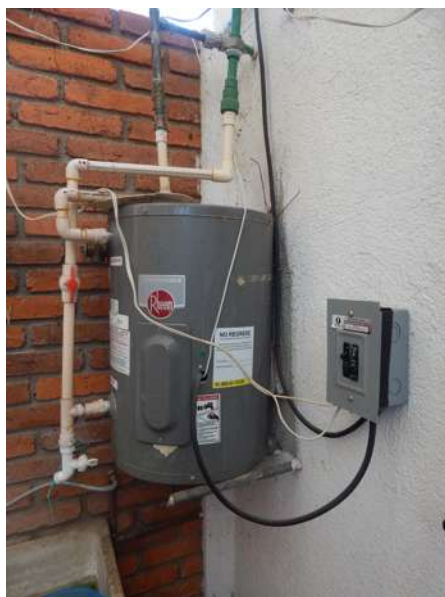
Figura 4.5: Boiler eléctrico para agua caliente sanitaria.
