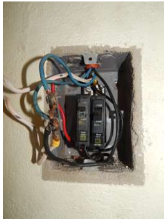
Figura 4.2: Conexión al tablero principal.
