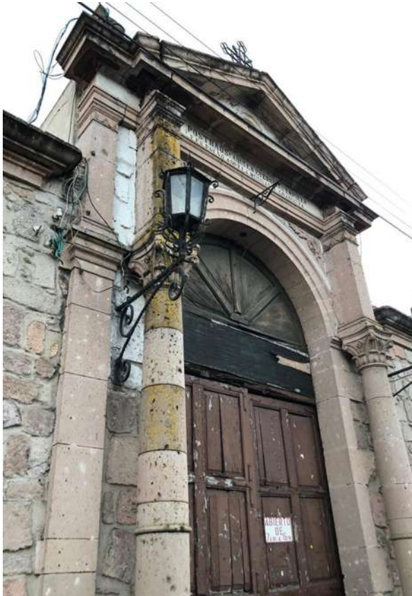
Fig. 89. La puerta se mantiene en mal estado debido a la falta de mantenimiento. Fuente: Tomada por María Alejandra López Vivanco (2023).
