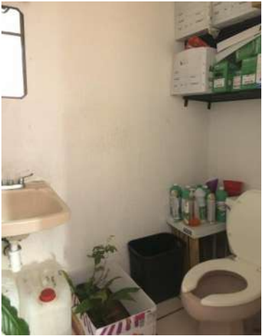
n. Sanitario administración
