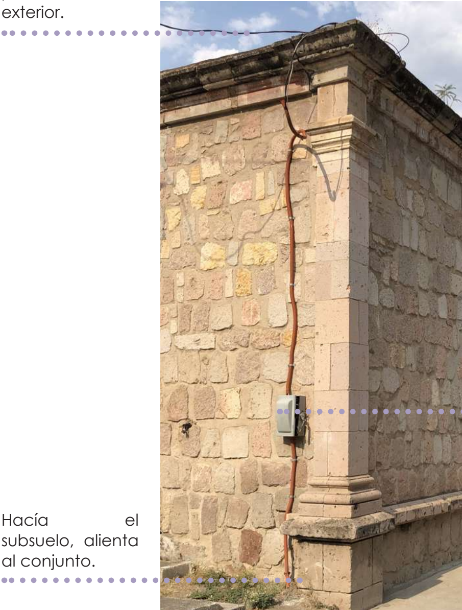
Fig. 78. Ubicación del tablero de carga 1. Fuente: Tomada por María Alejandra López Vivanco (2023).
