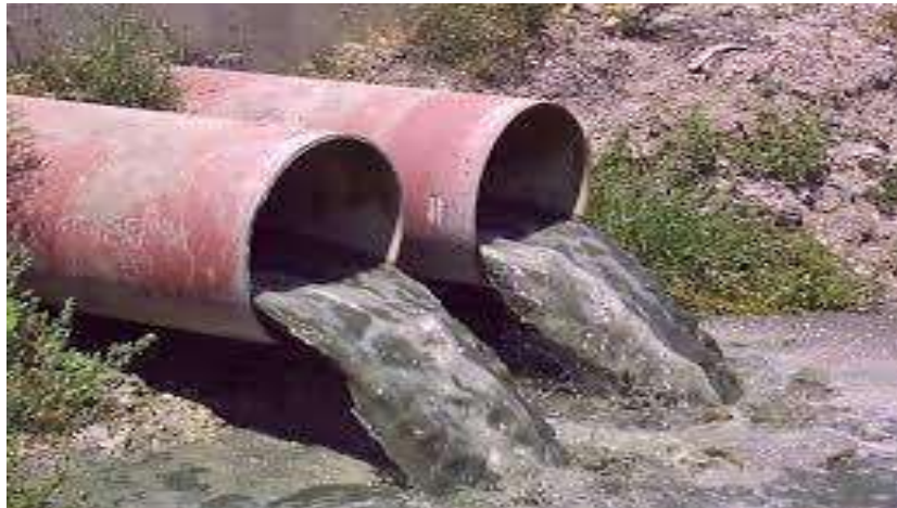
Figura 1. Aguas residuales sin tratar.
