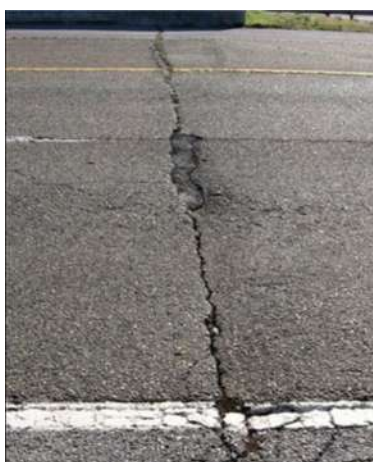
Imagen 3. Falla superficial. Fuente (Lingen Felder, 2022)
