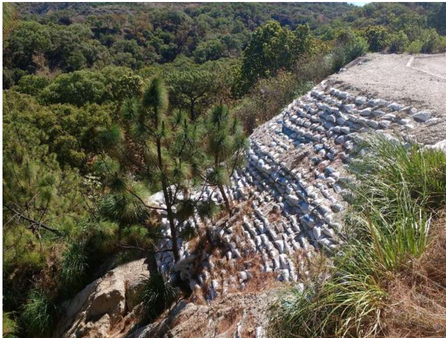
Figura 34. Borde de una de las plataformas de pozos geotérmicos donde se puede apreciar erosión de tipo remontante en la base del muro falso.
