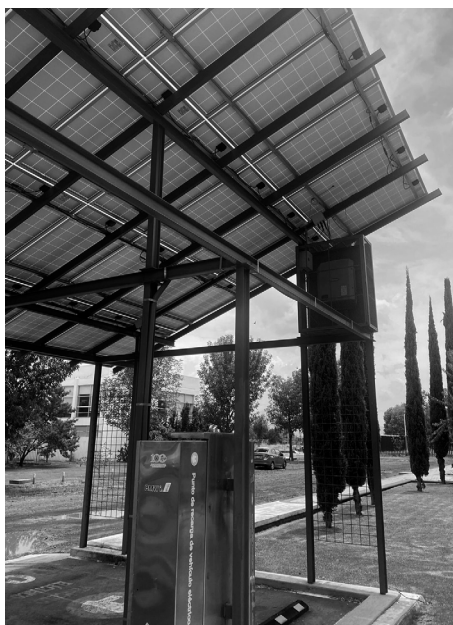
FIG.32 Vista interior del módulo de carga (Autor,2023)
