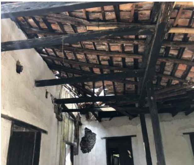
ILUSTRACIÓN 68:IMAGEN DETERIORO DE CUBIERTA, AUSENCIA DE MORILLO COMO SOPORTE ESTRUCTURAL POR MRLL CASCO DE EX HACIENDA SANTA MARIA.
