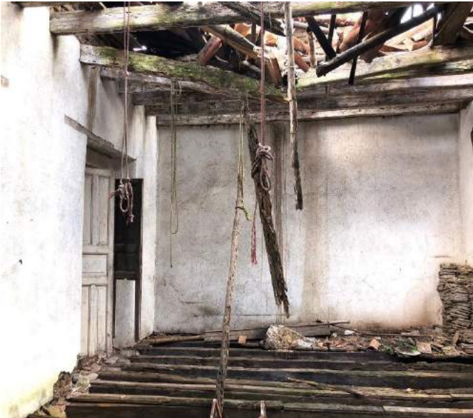
ILUSTRACIÓN 67:IMAGEN AUSENCIA DE ENTREPISO Y DETERIORO EN VIGUERÍAS DE MADERA POR MRLL CASCO DE EX HACIENDA SANTA MARIA.
