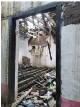
ILUSTRACIÓN 73:IMAGEN DETERIORO POR DERRUMBE DE ENTREPISO Y CUBIERTA POR MRLL CASCO DE EX HACIENDA SANTA MARIA.
